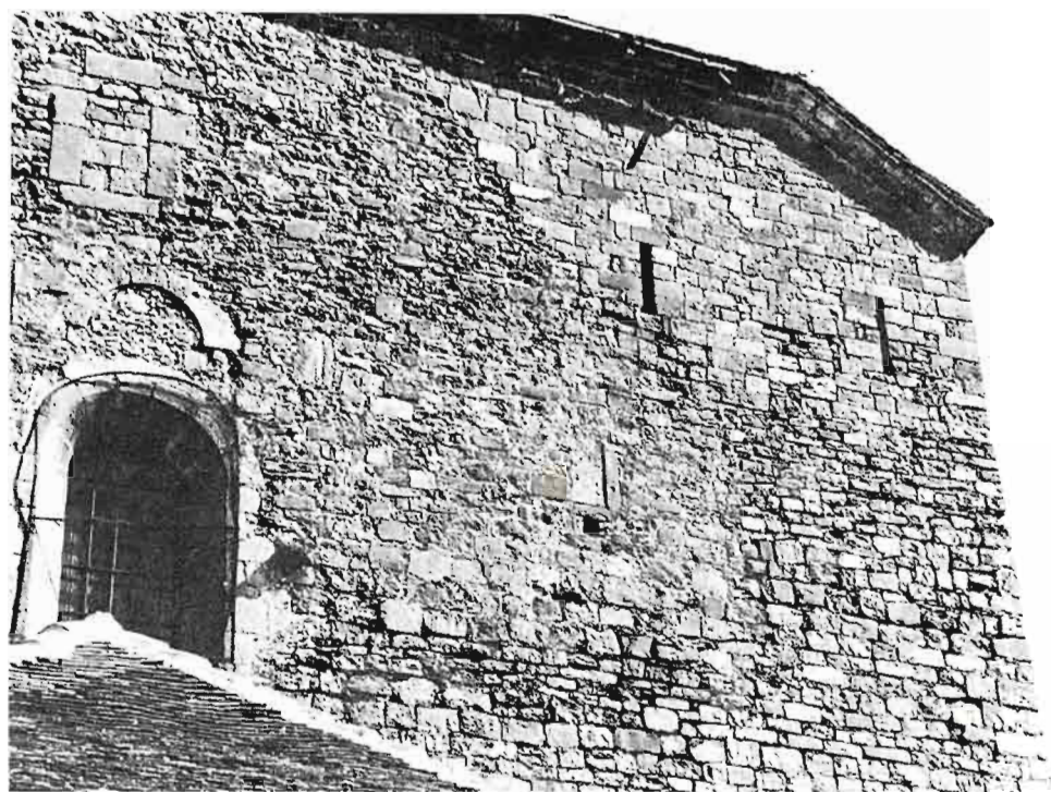
Foto 9: Fachada W antes de la restauración.
