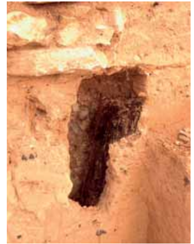
Figura 1. Poste de madera trabajado en el interior de un muro de adobe.
