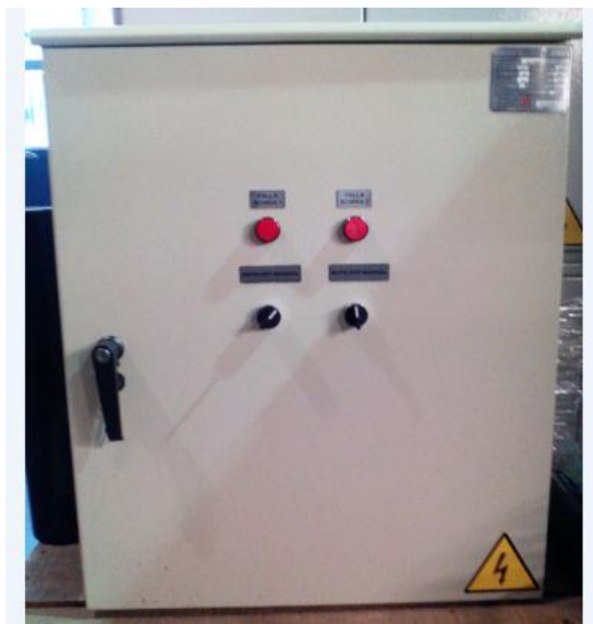
Imagen 3. Tablero eléctrico iQpum Micro 2 bombas cerrado.
