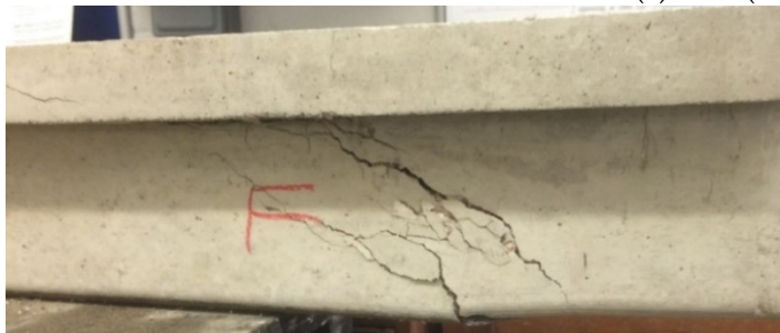
(b) S2-FRP0 (beam-end)
