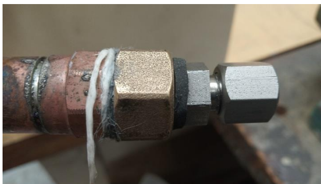
Obr. 24 Šroubení namontované v měděných rozvodech
