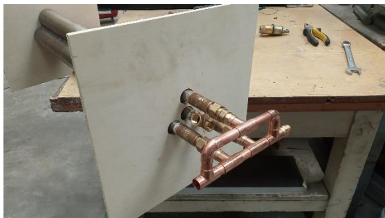
Obr. 21 Pohled na měděné rozvody
