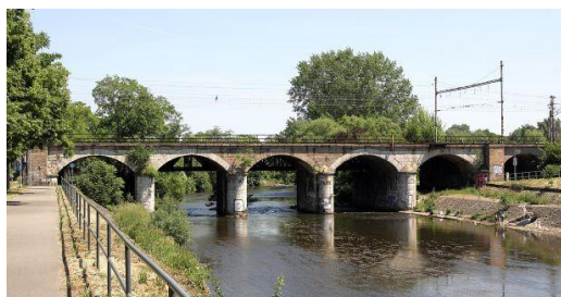
Obr. 91 Kamenný most přes řeku Svratku z roku 1838 zdroj: Encyklopedie mostů v čechách, na Moravě a ve Slezsku Stávající stav zdroj: KAM Brno
