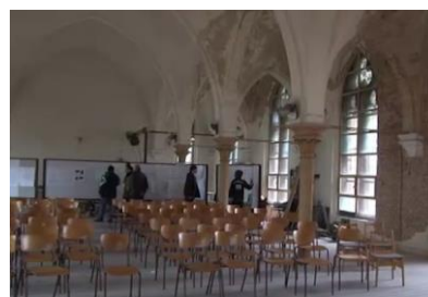
Obr. 252 Interiér kostela stav 2010 pohled na vložené železobetonové patro z druhé poloviny 20. století zdroj: záznam regionální televize
