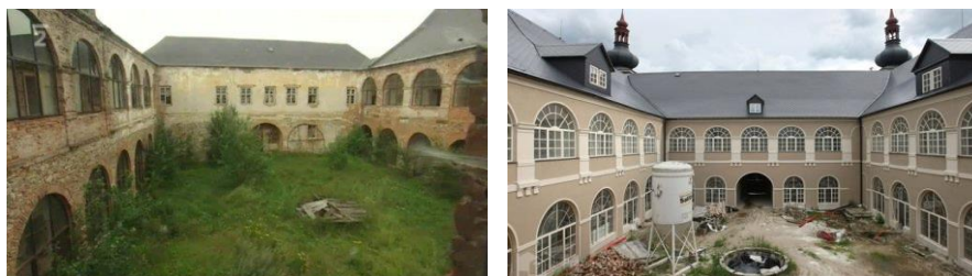
Obr. 39 Vnitřní nádvoří stav před rekonstrukcí v roce 2010 a v průběhu rekonstrukce 2014 zdroj: Česká televize zdroj: Prázdné domy.cz
