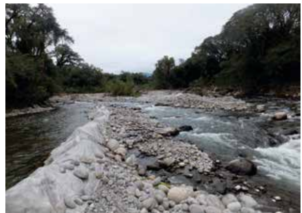
Figura 7. Río Pueblo Viejo. Toma de agua, a la izquierda.
