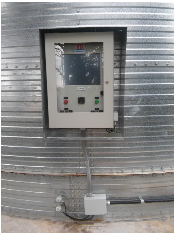
Foto 3 . Detalle del controlador del Silo Secador de INTA
