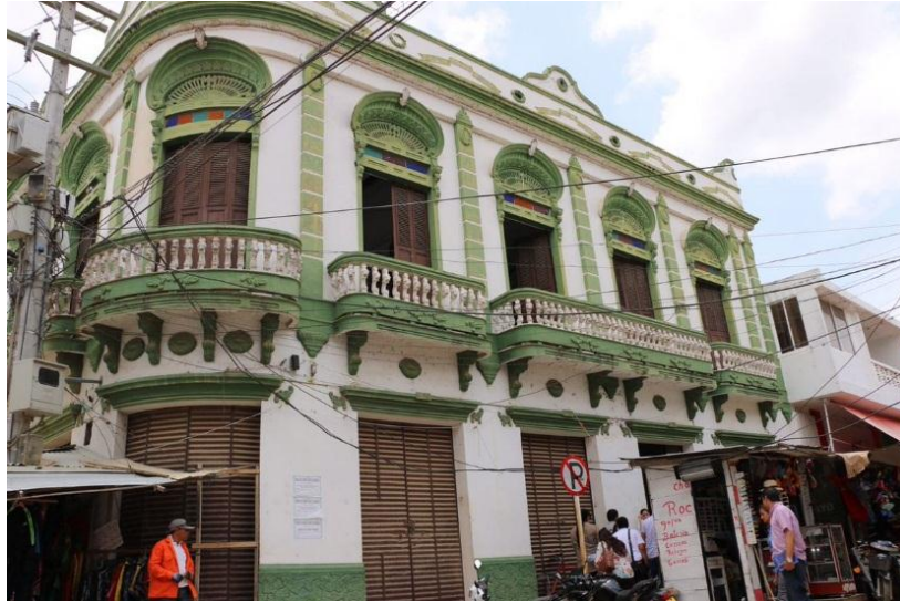
Figura 22. Edificio Caraballo en completo abandono Fuente: Google, año 2014
