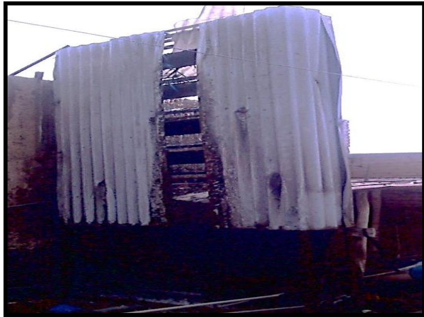
Figura 17: Torre de enfriamiento.
