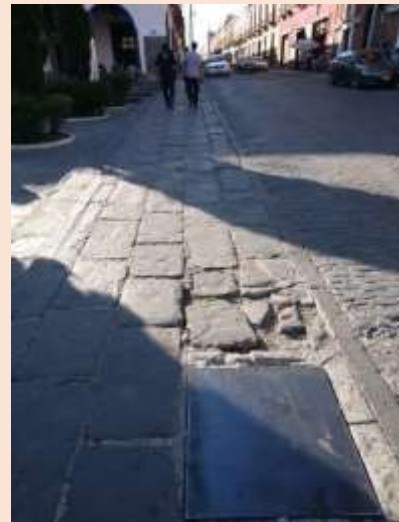
Imagen 1. Diagnostico urbano, banquetas en malas condiciones
