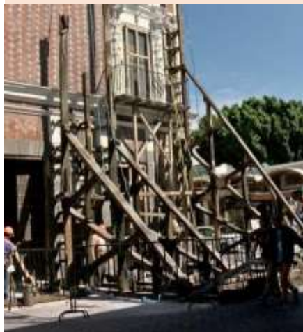
Imagen 3. Diagnostico urbano, inmuebles con daños a causa del sismo
