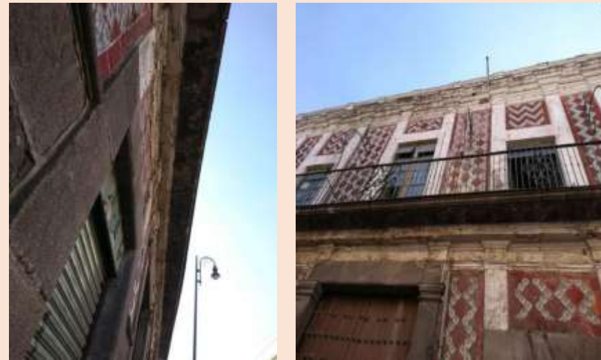
Imagen 2. Diagnostico urbano, inmuebles dañados por sismo Casa Toledo
