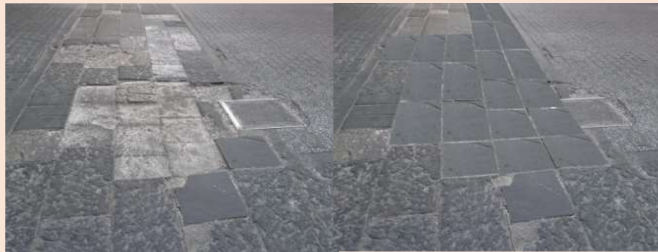
Imagen 4.4.1 Piezas de piedra de cantera dañadas
