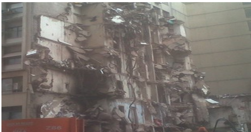
Figura 1 - Desabamento do Edifício Liberdade
