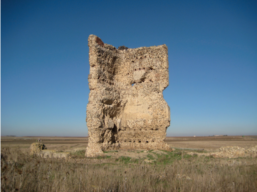
Figura 6. Ruina de torre en el despoblado de Torre de Astudillo, en el que se observa el empleo discontinuo del ladrillo, que no recorre todo el espesor del paramento.
