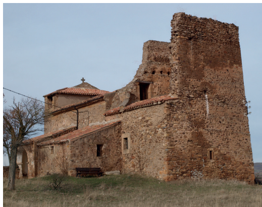
Figura 22. Iglesia de Montenegro de Ágreda, con la torre primigenia semiderruida en donde se puede apreciar la puerta original de acceso a la altura de la planta primera. Fotografía del autor, 2015.
