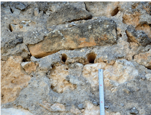
Figura 26. Agujal de varillas de pareadas en la muralla de Fuentidueña, Segovia. Fuente: Alicia Sainz Esteban. Fecha de captura: 23/07/2016.
