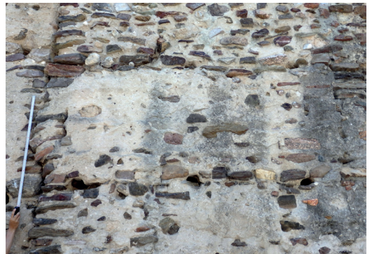
Figura 23. Tapia unitaria de la muralla de Coca, donde se ve un murete transversal en el lateral izquierdo. Fuente: Alicia Sainz Esteban. Fecha de captura: 14/08/2016.
