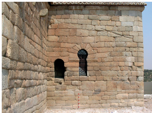
Figura 7. Detalle de las fábricas ajustadas a regla en la iglesia de Santa María de Melque
