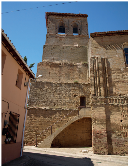
Figura 5. Torre de la iglesia de Boadilla de Rioseco (Palencia), con retallos exteriores que marcan los distintos niveles, siendo los dos primeros de piedra y el resto de ladrillo. La puerta de acceso se sitúa a la altura del primer nivel. Fotografía del autor, 2015.
