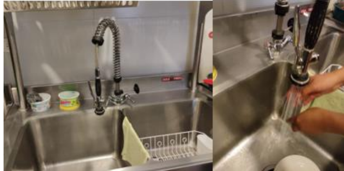
Figura 18. Llaves de agua de la cocina
