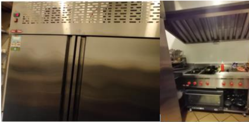
Figura 27. Equipos de cocina nuevos
