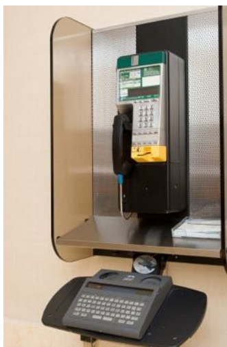
Fotografia 1 - TTY instalado em um orelhão
