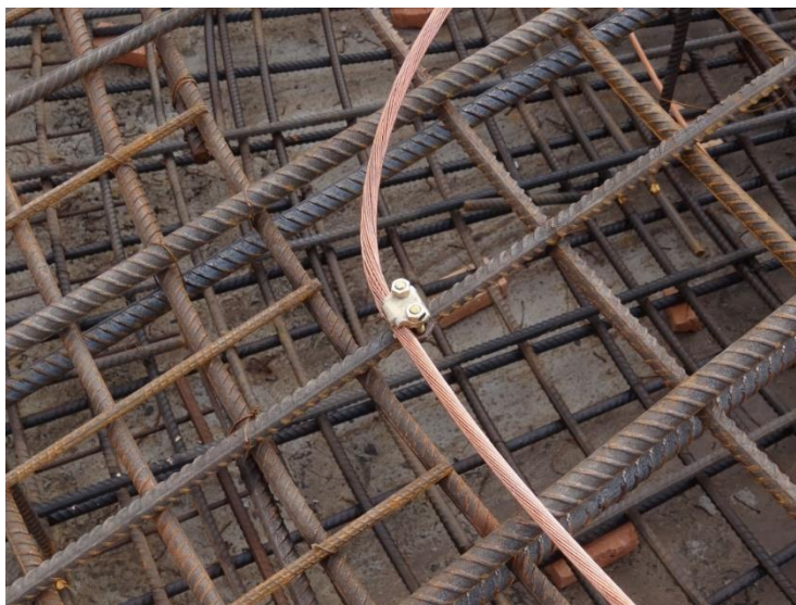
Foto 13 – Malha de Aterramento Ligada às Armaduras do Bloco
