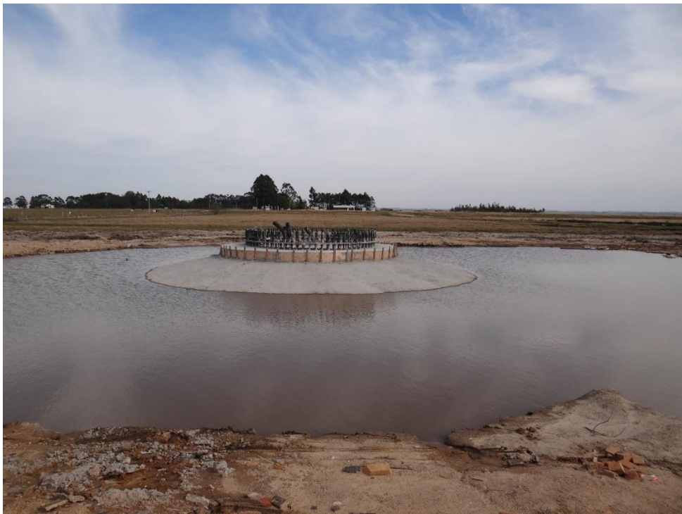
Foto 22 – Bloco de Coroamento Quase Totalmente Submerso
