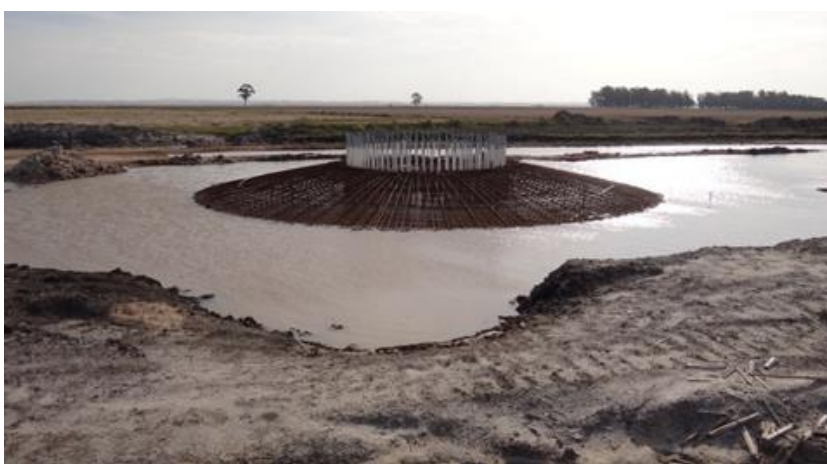
Foto 20 – Bloco de Coroamento Quase Totalmente Submerso
