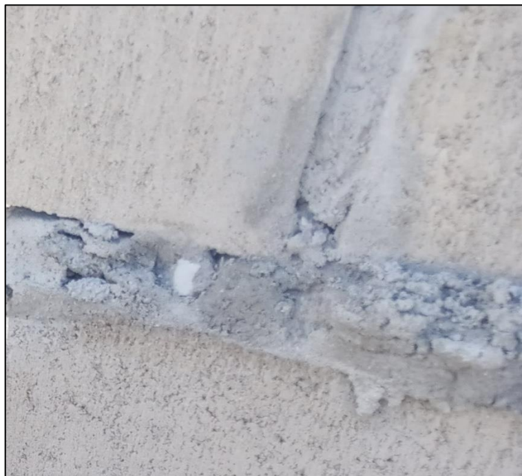
Figura 46 - Juntas de assentamento mal acabadas
