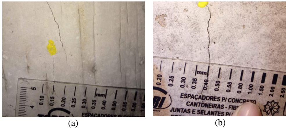
Figura 10 - Utilização de fissurômetro para identificar espessura das fissuras, onde (a) apresenta uma fissura com 0,15mm e (b) uma fissura com 0,40mm
