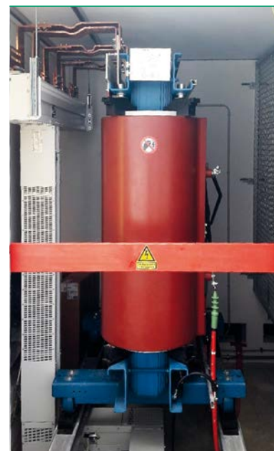
■ Abb. 3: Transformator (Foto: © Siemens AG).
