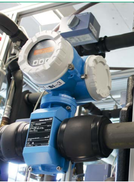
■ Abb. 3: Volumenstromsensor der Versuchsanlage für Wärmepumpen (Foto: Christian Wißler).
