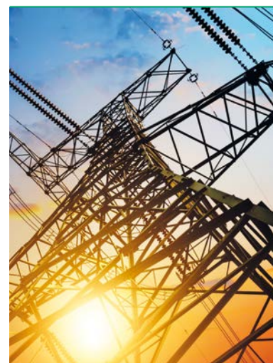
■ Abb. 1: Elektrischer Hochspannungsmast (sst).
