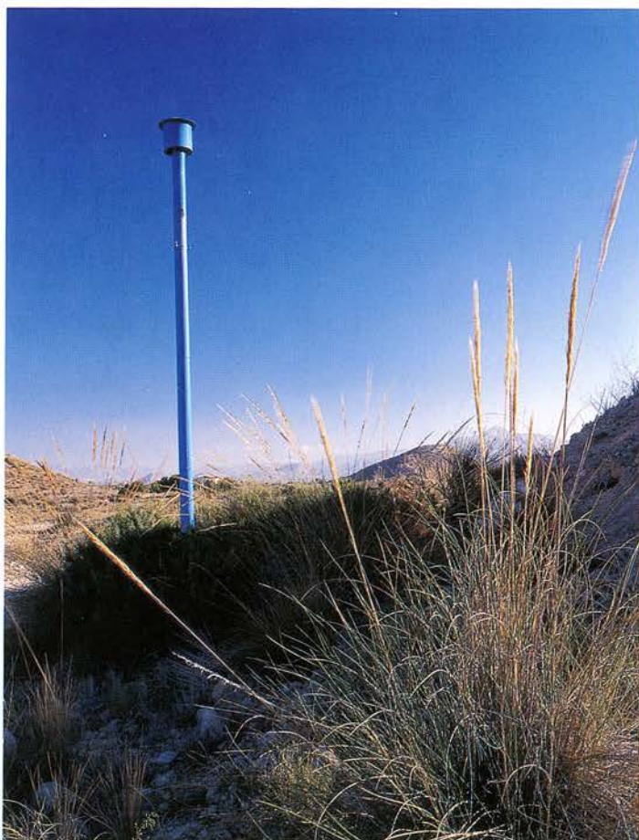
La red totalmente controlada es objeto de continuas revisiones y adecuaciones. En la foto se muestra uno de los respiraderos existentes en el conducto del Canal del Cid en el medio Vinalopó.
