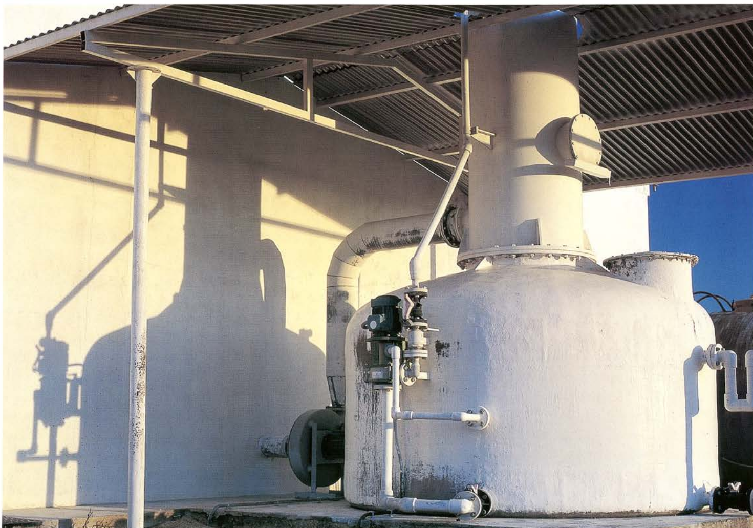
Sistema de cloración en las aguas de abastecimiento de Alicante procedentes de los pozos y antes de circular por el Canal del Cid (foto F. Albert y E. Ortiz).
