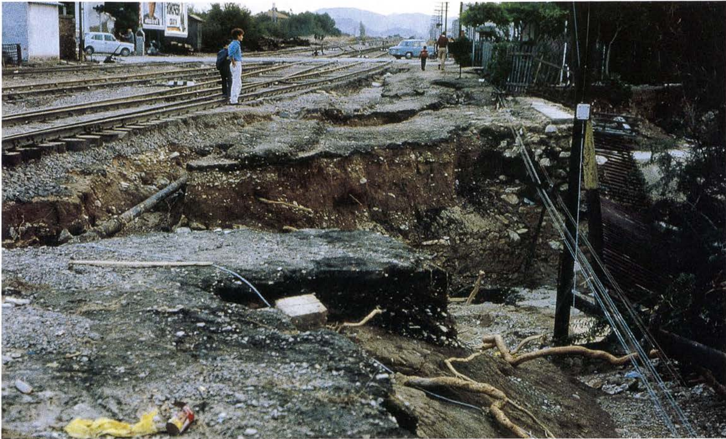
Situación en que quedaron las vías del tren en la Estación de Renfe tras una avenida. Barranco de San Agustín.
