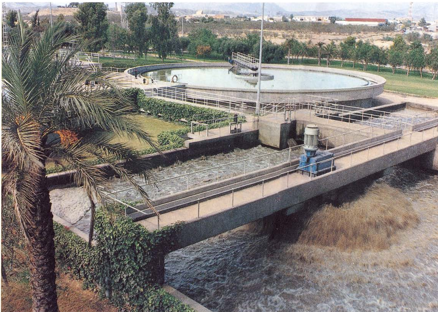
Sistema de aeración de la EDAR (Rincón de León).
