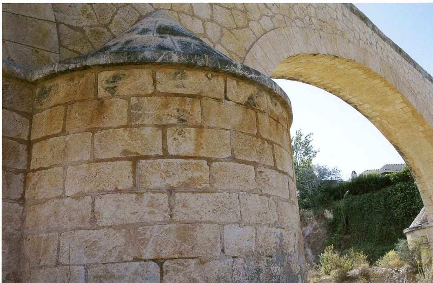
Contrafuerte del Acueducto de Santa Ana, perteneciente a la Traída de Aguas de Sax. Canal del Cid (foto F. Albert y E. Ortiz).
