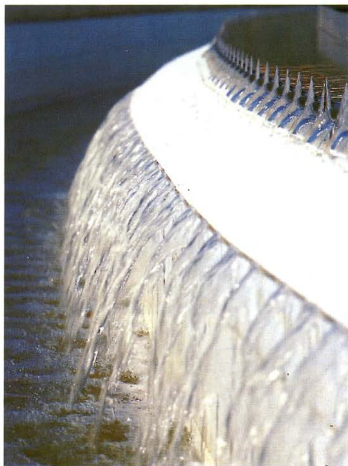
Salida de agua del decantador secundario.
