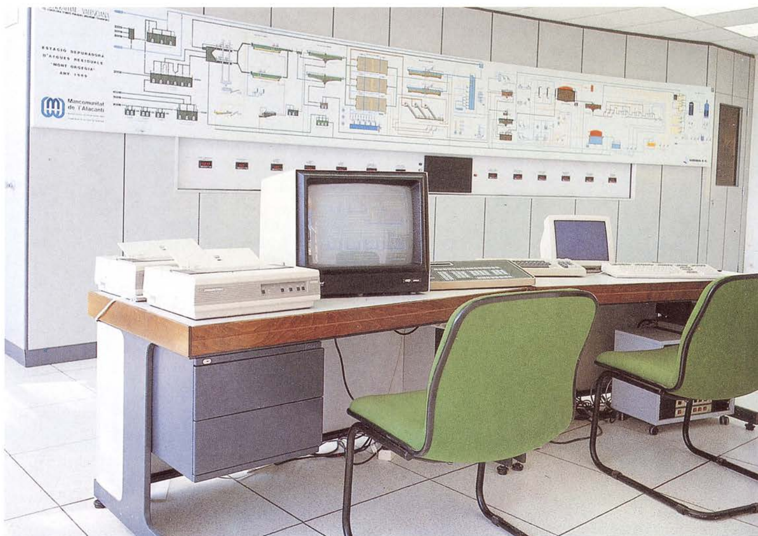
Telecontrol de la EDAR.
