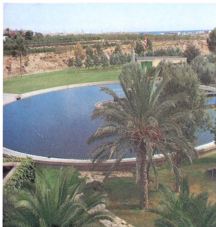
Sistema de depuración de la E.D.A.R. de Rincón de León. Decantador secundario.
