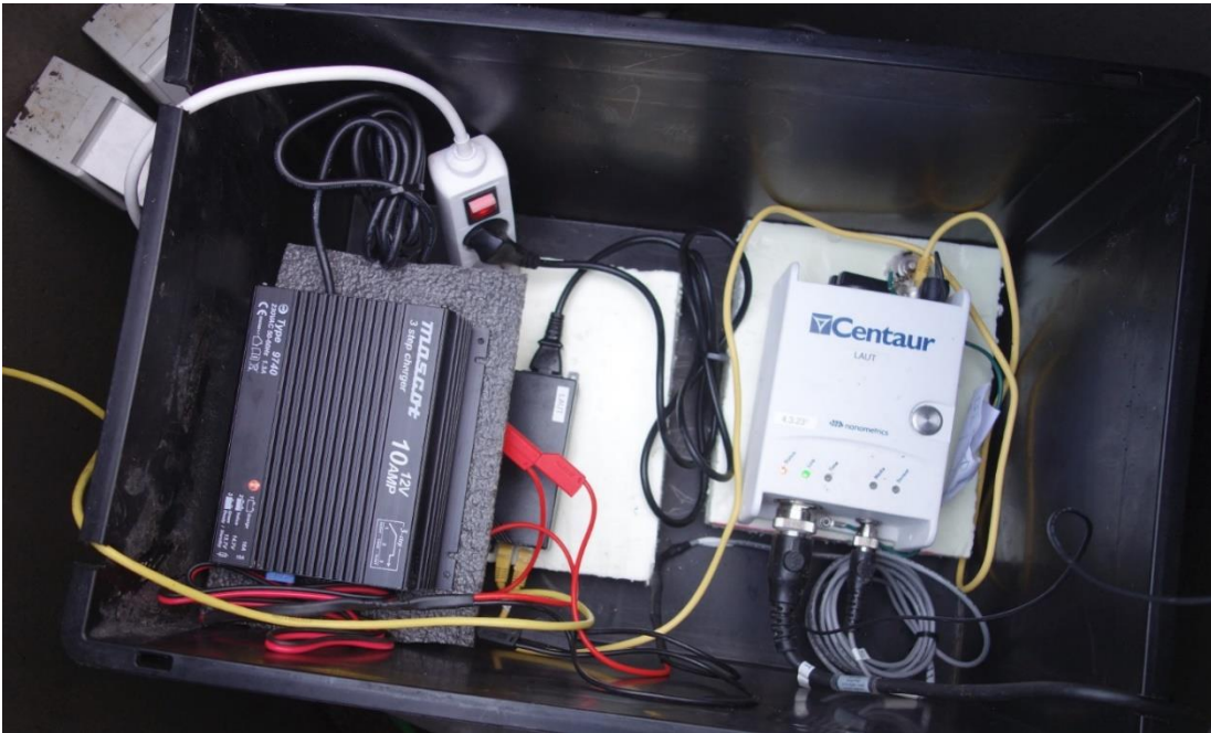
Kuva 6. KUNI-aseman kaivonrenkaan sisällä on erillinen taso seismometrin yläpuolella. Kosketusta maahan ei ole. Laatikko on asetettu tason päälle laitesuojaksi. Kaikki laitteet ovat kosteisiin tiloihin sopivia.
