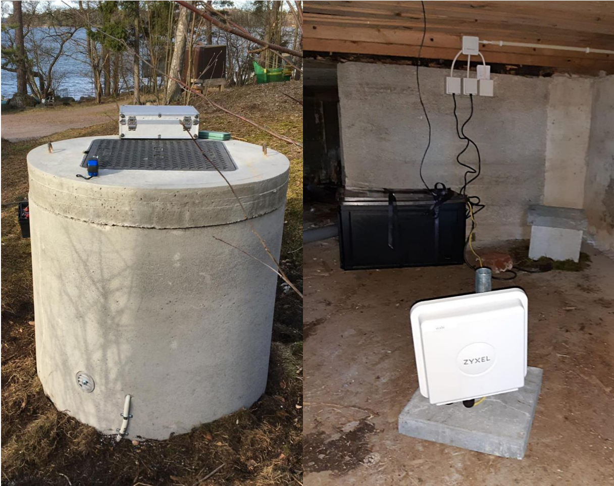
Kuva 1. Vasemmalla näkyy Lauttasaaren seismisen aseman laitesuoja ja oikealla Vuosaaren aseman maanalaista infrastruktuuria. LAUT-aseman betonikannen päälle joulukuussa 2020 asennettua lisäkantta ei näy keväällä 2020 otetussa kuvassa. VUOS-aseamalla seismometri sijaitsee takaoikealla näkyvän betonikannen alla.
