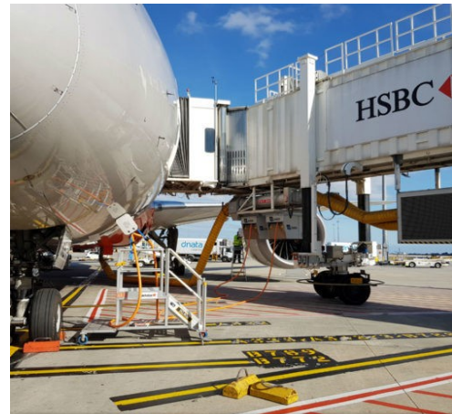
Obrázek 2: GPU umístěné na konstrukci nástupního mostu [13]
