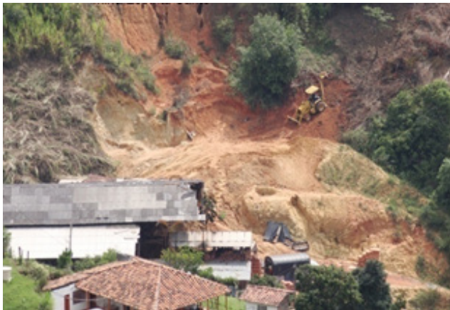
Figura 5. Desestabilización de taludes, vereda los Gómez Fuente: Elaboración propia (2013)
