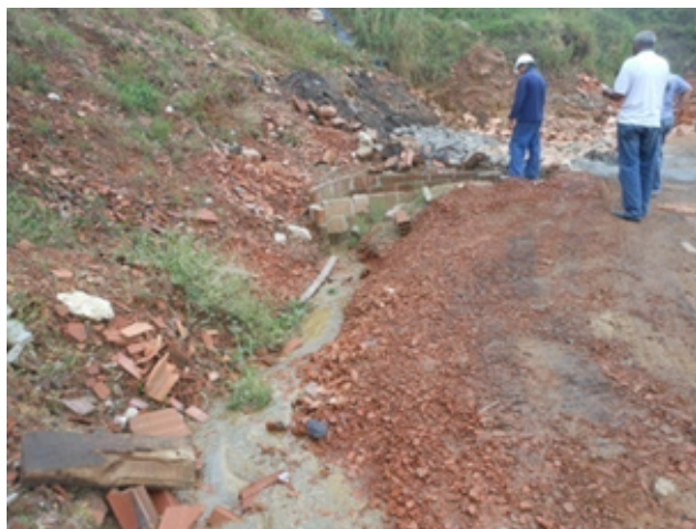
Figura 3. Situación y afectación del suelo, vereda Los Gómez
