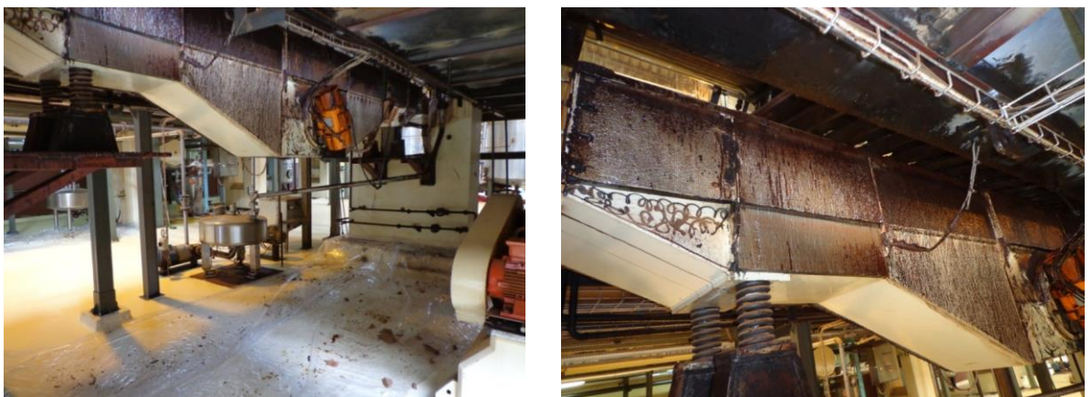
Figura 9 - Resíduos gerados por queda do produto
