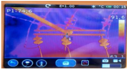
Gambar 5. Pengukuran Suhu titik sambungan jenis Live Line pada Penyulang Tondon
