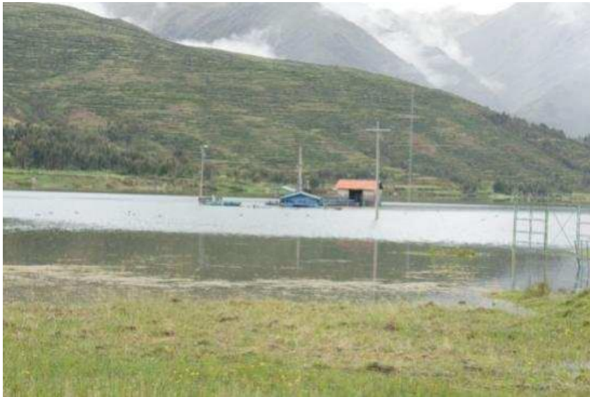
Fotografía N° 2 Estación de bombeo flotante – Laguna Piuray
