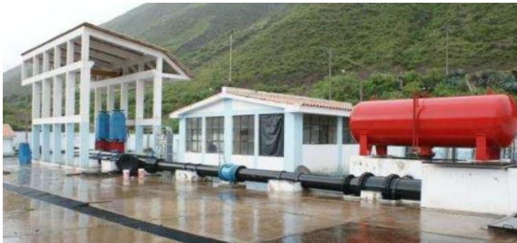
Fotografía N° 5 Estación de Bombeo de Qollana
