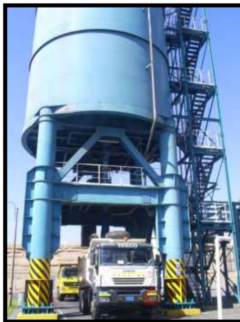
Figura 6: Silos donde se almacena la Ceniza Volante
