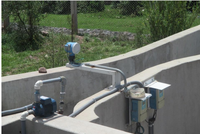
FIGURA N°53: CANAL PARSHALL DE SALIDA DE AGUAS RESIDUALES DE LA PTAR SAN JERÓNIMO
