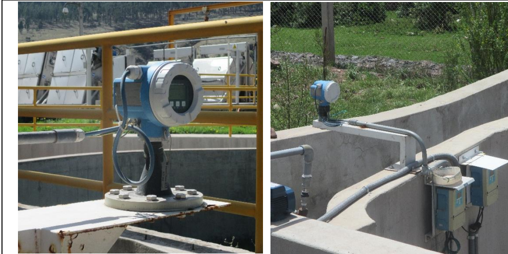
MEDIDOR AUTOMATIZADO DE CAUDALES (AFLUENTE Y EFLUENTE)
