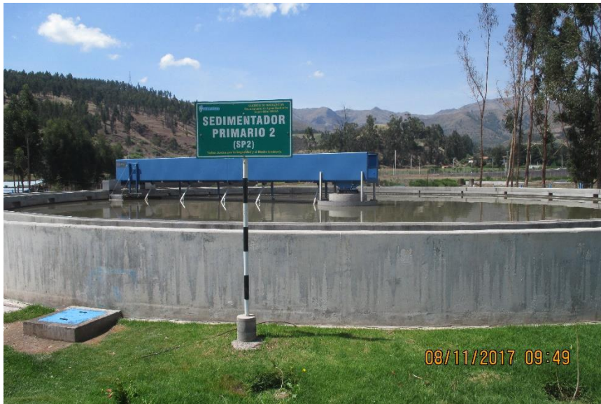
FIGURA N°15: SEDIMENTADOR PRIMARIO N°02 DE LA PTAR SAN JERÓNIMO
