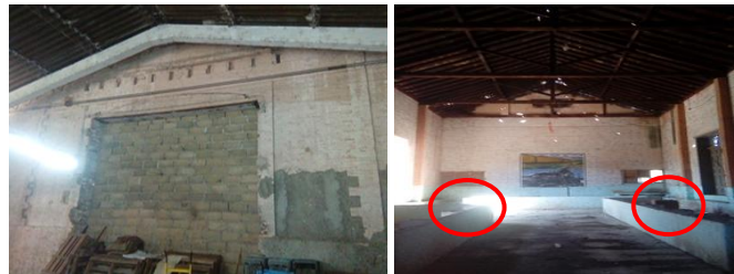
Fig. 13 Vanos tapiados y otros se abrieron para colocar carpinterías (circuladas en color rojo) Fuente: Fotos tomada por la autora, mayo 2018
