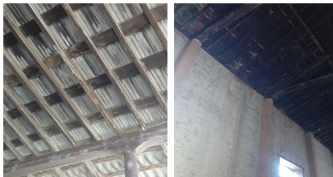
Fig. 11 Microorganismos en vigas de cubierta y entablado Fuente: Fotos tomada por la autora, mayo 2018
