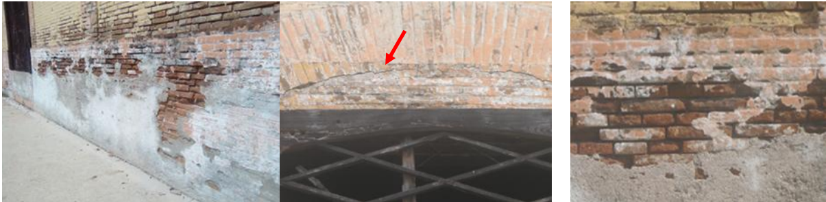
Fig. 12 Erosión y grietas en muros (Señalada con flecha de color rojo) Fuente: Fotos tomada por la autora, mayo 2018
