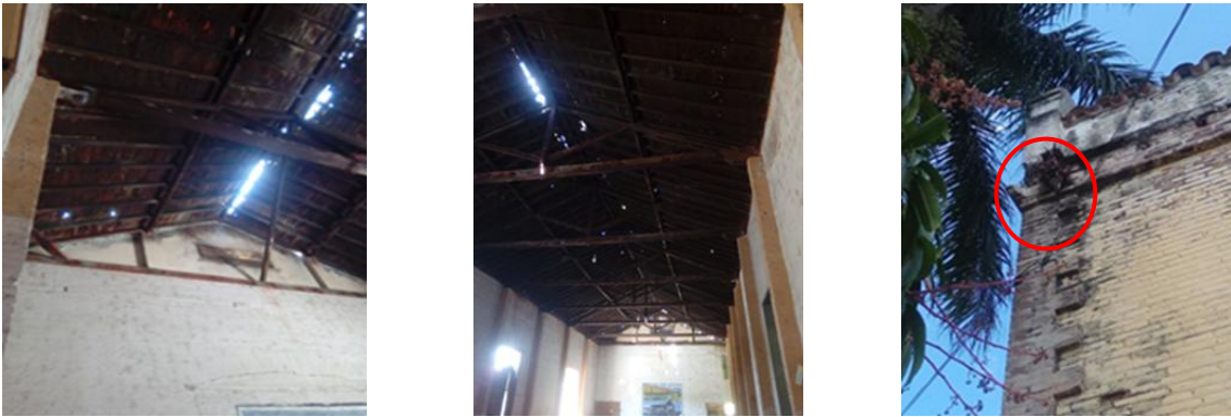
Fig.9 Deterioros en cubierta y plantas parásitas (señalada con círculo de color rojo) Fuente: Fotos tomada por la autora, mayo 2018
