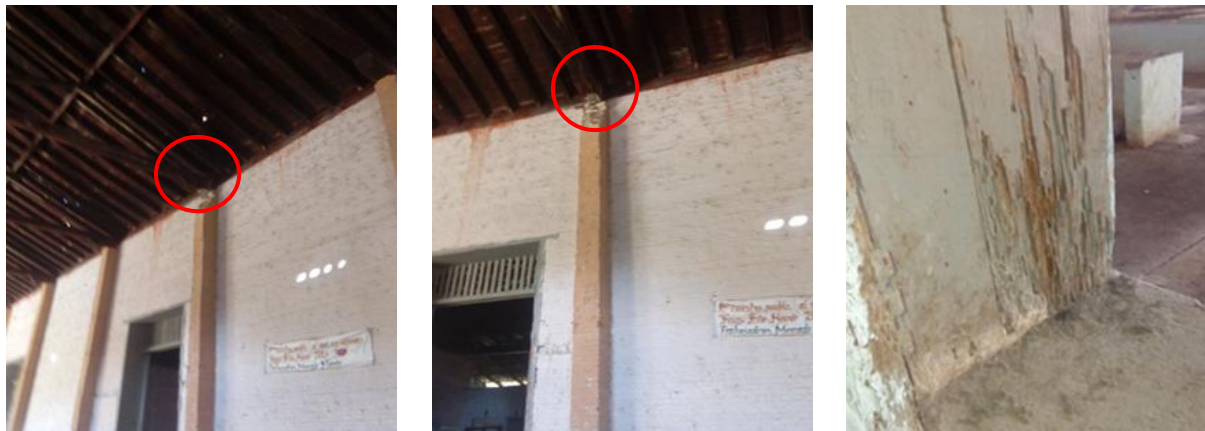
Fig. 10 Pérdida de sección de pilastras en la zona de apoyo de las cerchas (señalados con círculos de color rojo) y presencia de microorganismos en carpintería Fuente: Fotos tomada por la autora, mayo 2018
