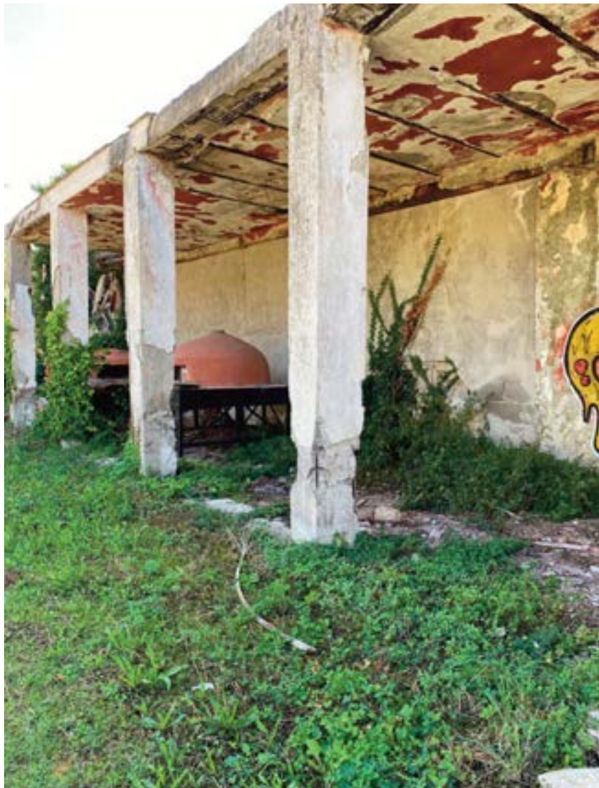
4. Napoli Mostra d'Oltremare. Padiglione Libia. La fatiscenza delle strutture in cemento armato e ferro del Padiglione Libia.
