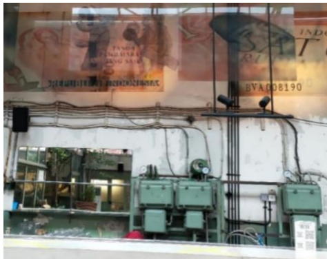
Gambar 27. Bekas Panel Listrik di Bar Sumber: Survei lapangan, 2020.
