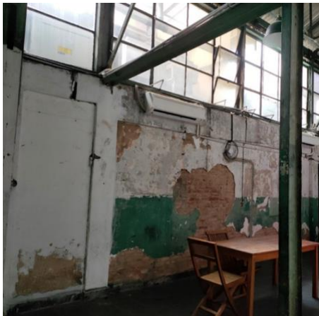
Gambar 20. Kondisi Dinding Terkelupas Sumber: Survei lapangan, 2020.
