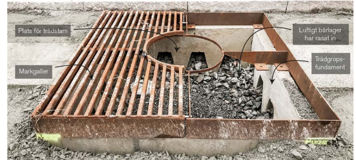
Figur 34. I en trädgrop innan plantering syns hur makdamblandningen från förstärkningslagret har rasat in genom fundamentets hålrum och hur markgallret placeras ovanpå fundamentet.
