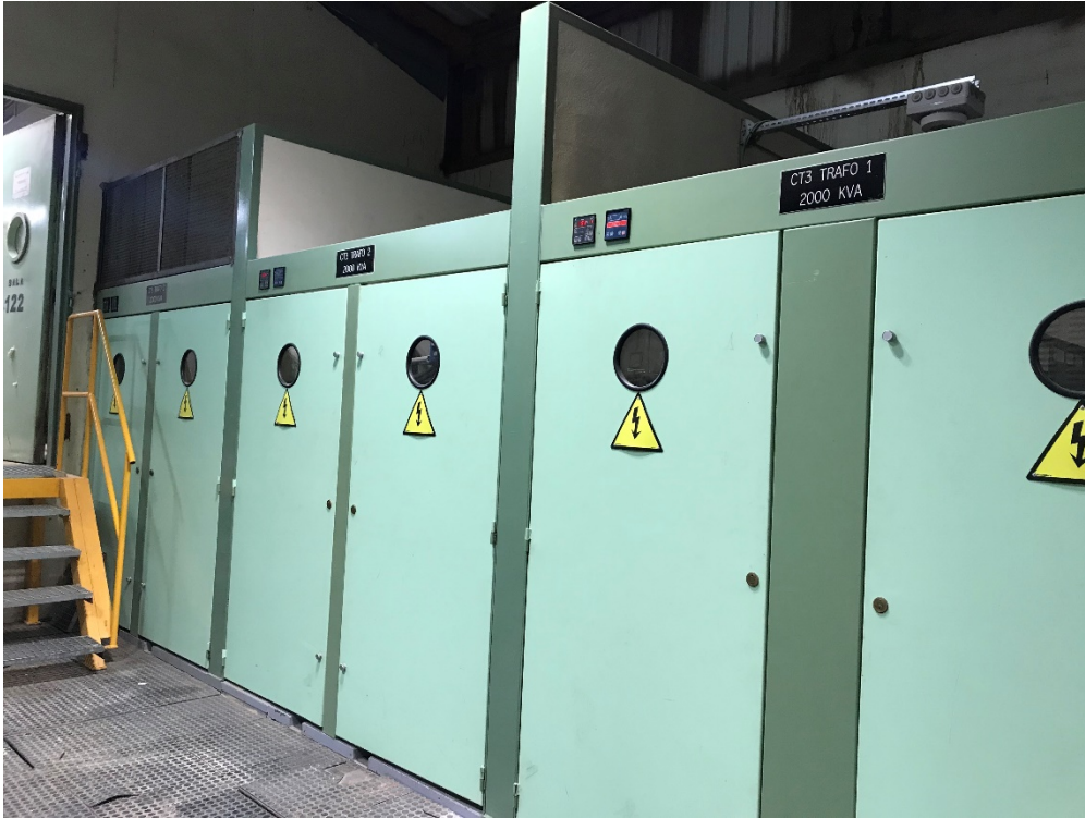
Imagen 3: Sala eléctrica CT3 donde se encuentran los tres transformadores 1,2 y 3 de 2000KVA aguas abajo del transformador de 10MVA.
