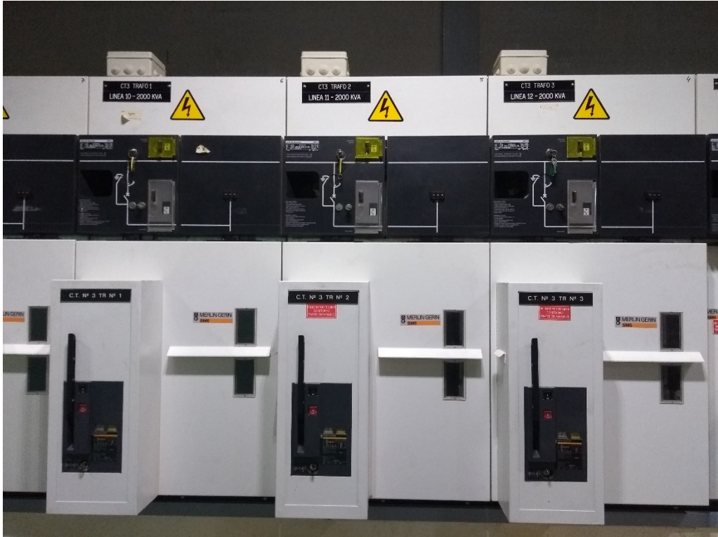
Imagen 6: Celdas de distribución en media tensión existentes de los transformadores 1, 2 y 3 de 2000KVA.
