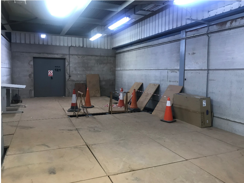
Imagen 10: Sala eléctrica existente donde van colocados los cuadros eléctricos de la línea de limpieza.
