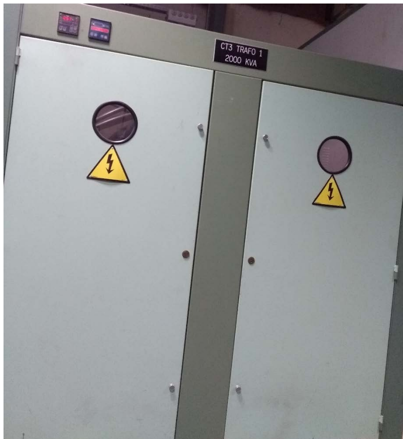
Imagen 4: Transformador 1 de 2000 KVA del que se alimenta la línea comunes.
