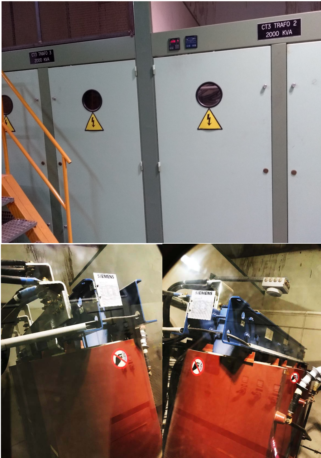
Imagen 5: Transformador 2 y 3 de 2000 KVA conectados en paralelo del que se alimentan las líneas 1 y 2.
