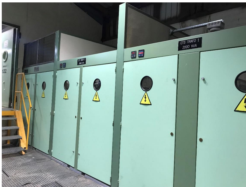
(Anexo de fotografías de la instalación : Imagen 3: Sala eléctrica CT3 donde se encuentran los tres transformadores 1,2 y 3 de 2000KVA aguas abajo del transformador de 10MVA).
