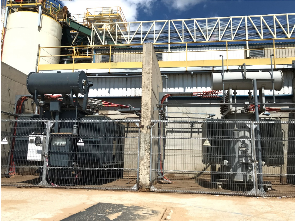
Imagen 1: Transformadores 45kV / 6kV (10MVA y 5MVA) a la llegada del CT2.
