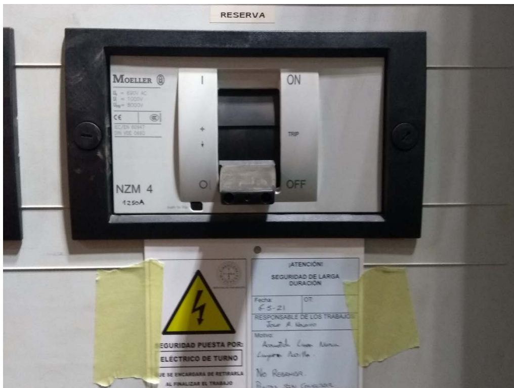
Imagen 7: Interruptor automático general CDB2.43 acometida de la Línea Comunes NZM 4 3P 1250A ya existente de reserva.
