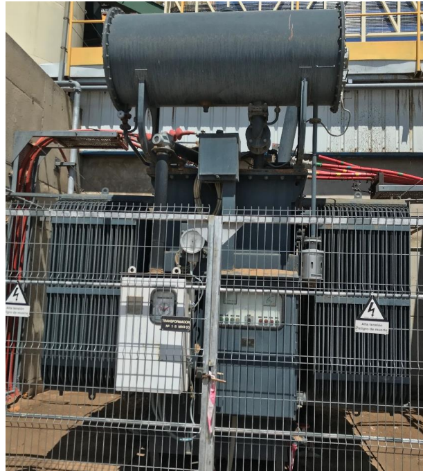
(Anexo de fotografías de la instalación: Imagen 2: Transformador 45kV / 6kV 10MVA donde parte la instalación).
