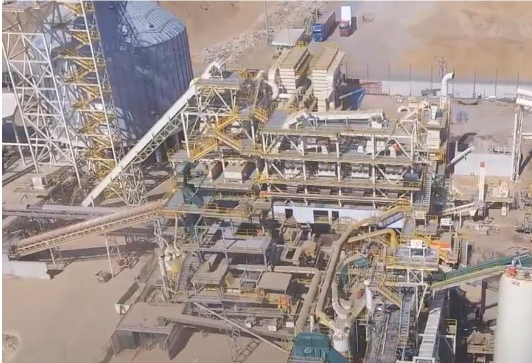
(Anexo de fotografías de la instalación: Imagen 17: Montaje de la maquinaria de la línea de limpieza (Vista frontal)).
