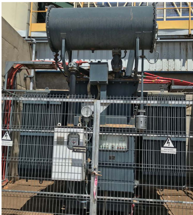
Imagen 2: Transformador 45kV / 6kV 10MVA donde parte la instalación.
