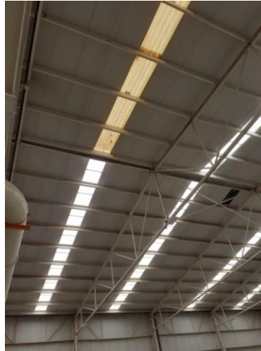
Imagen 38: Diferencia entre paneles traslúcidos nuevos y antiguos.
