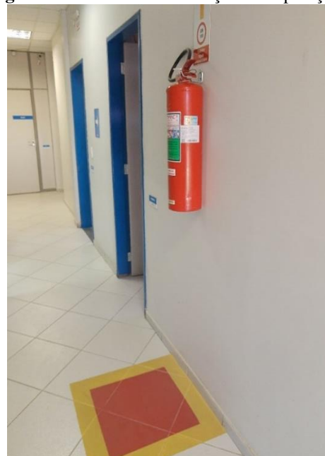
Figura 10: Extintor em condições de operação.
