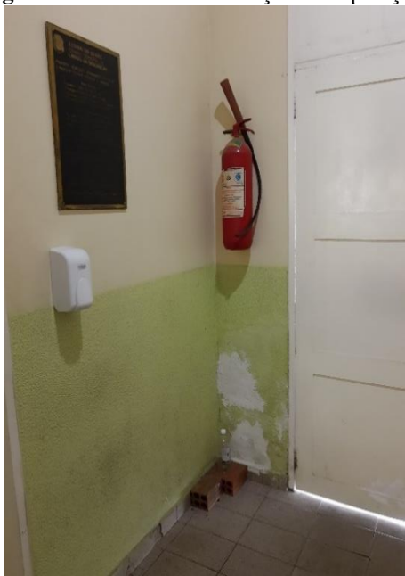
Figura 9: Extintor sem condições de operação.
