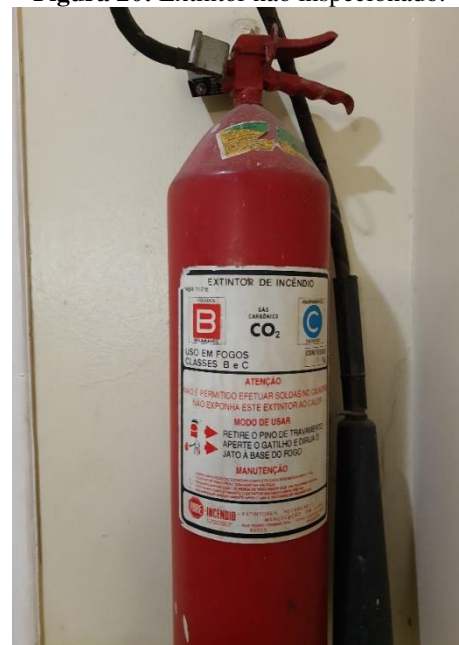
Figura 20: Extintor não inspecionado.
