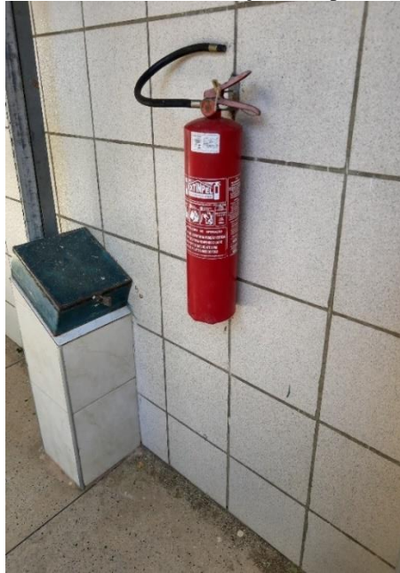
Figura 12: Extintor sem sinalizações nas paredes e pisos.
