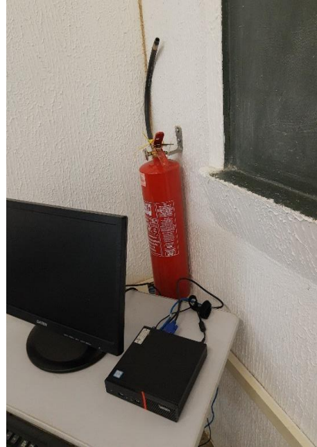
Figura 18: Acesso obstruído ao extintor.
