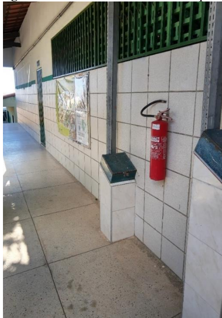
Figura 16: Extintor com altura inadequada.
