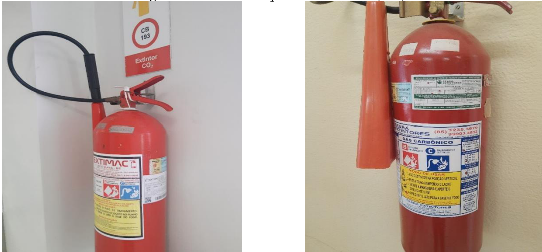
Figura 14: Extintor adequado ao ambiente a) e b).
