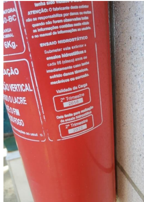
Figura 22: Extintor com a validade fora de conformidade.
