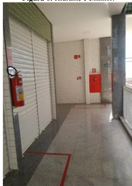
Figura 6: Hidrante e extintor.
