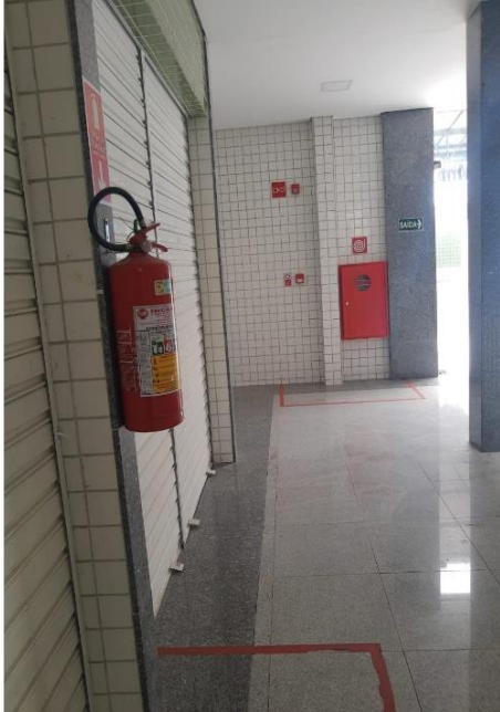
Figura 17: Acesso desobstruído ao extintor.
