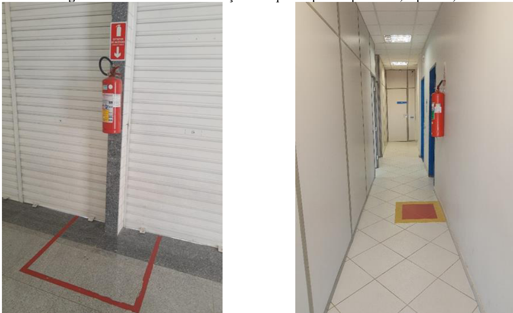
Figura 11: Extintor com sinalizações adequadas para as paredes a) e pisos b).
