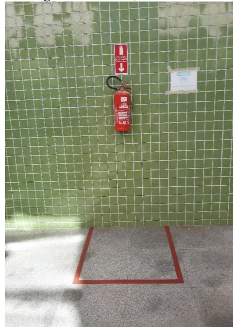
Figura 8: Extintor, área externa.
