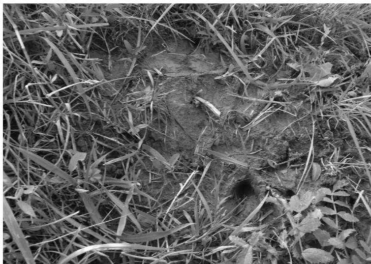
2. ábra Taposási kár a mentett oldalon (fotó: Sallai András) Figure 2. Treading damage in the protected side
