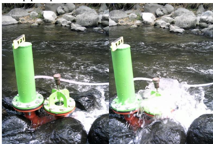
Gambar 8. Pompa hidram setelah dipasang dan mengalirkan air
