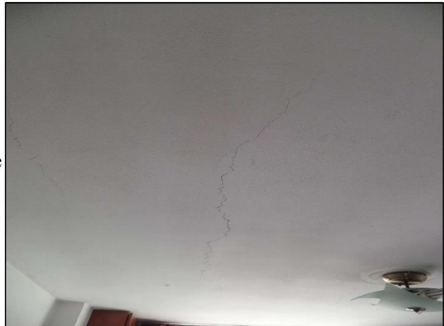
Debido al asentamiento del suelo se puede apreciar rajaduras en la losa del segundo nivel.
