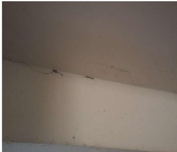
Rajadura en el tarrajeo de la union de la losa y la viga peraltada.
