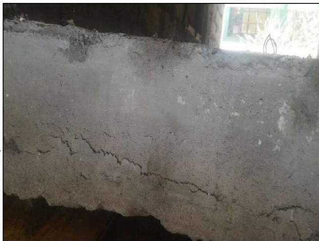
Problemas de cangrejera en la losa, además se observa rajaduras en la losa.
