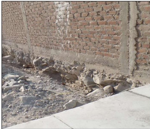
Cimentación poco profunda de 0.5 m se puede apreciar a simple vista.
