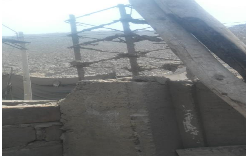
Figura 124. Corrosión del acero.
