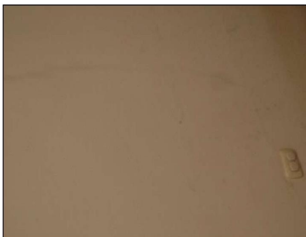
Pequeñas fisuras en algunos muros.
