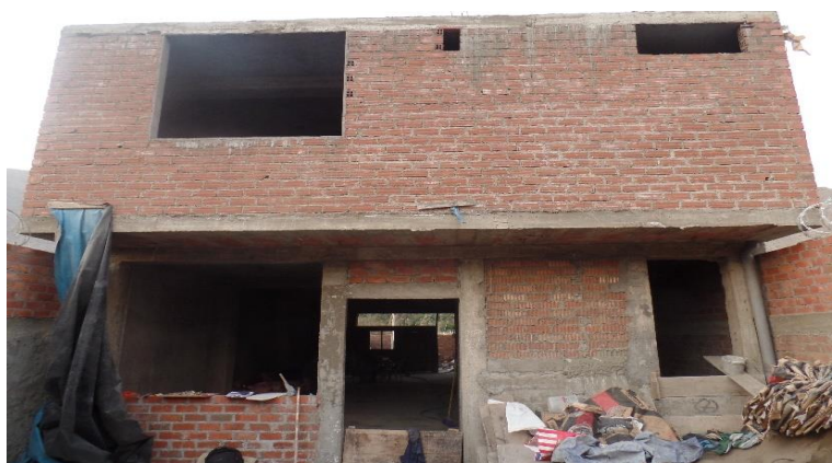
Figura 119.Tabiquería sin arriostramiento.
