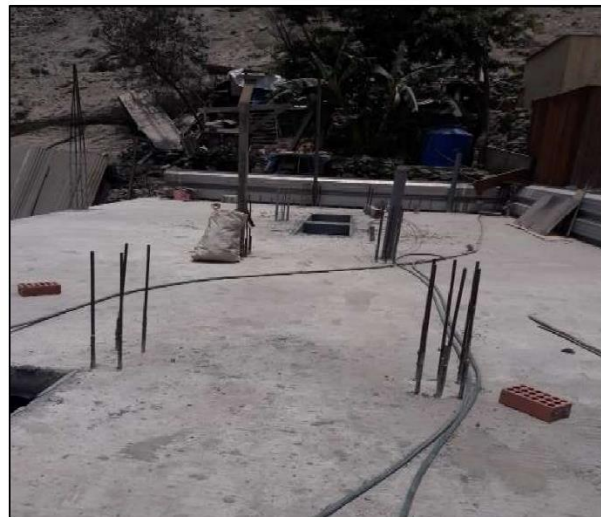
Corrosión del acero en la azotea de la vivienda
