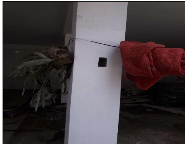
Debilitamiento de la columna por parte del propietario mediante la colocación de interruptores.
