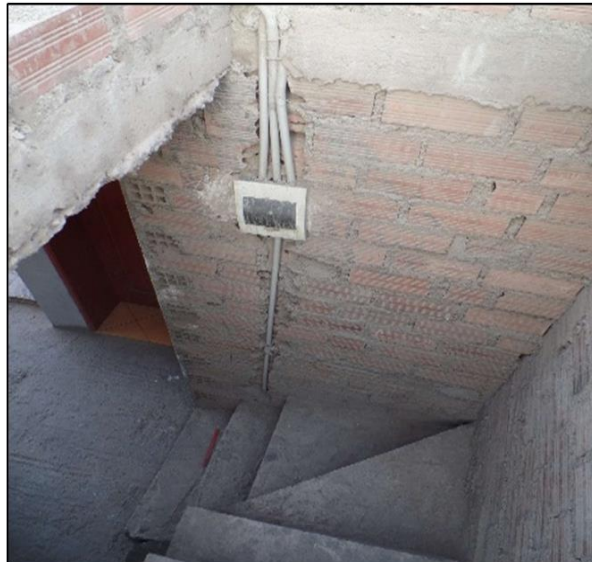
Debilitamiento del muro, la viga y la losa debido a la mala planificación de las instalaciones eléctricas
