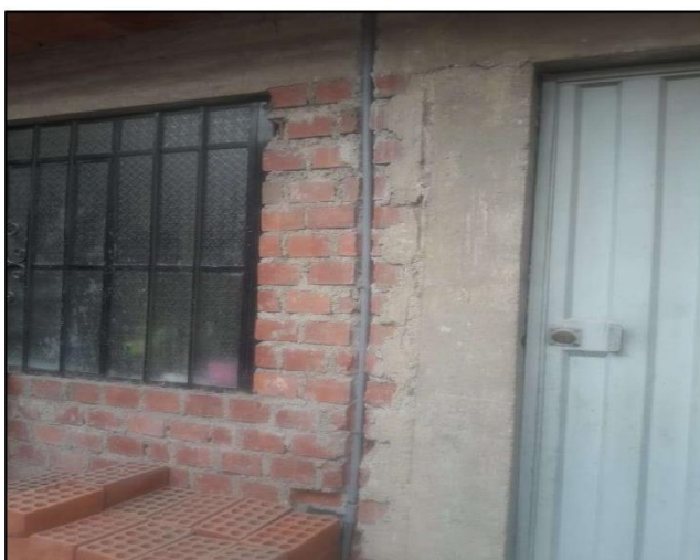
Debilitamiento de la viga debido a mala planificación de las instalaciones eléctricas en la vivienda.
