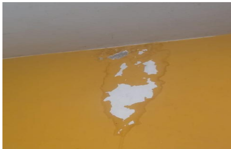
Figura 125. Humedad en los muros.
