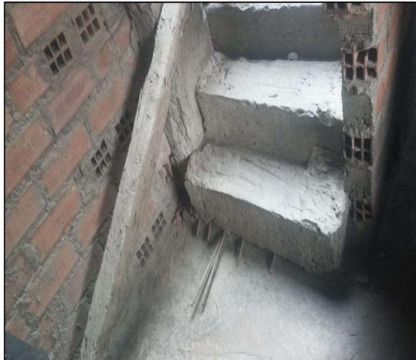
Mal amarre de la escalera y la losa.
