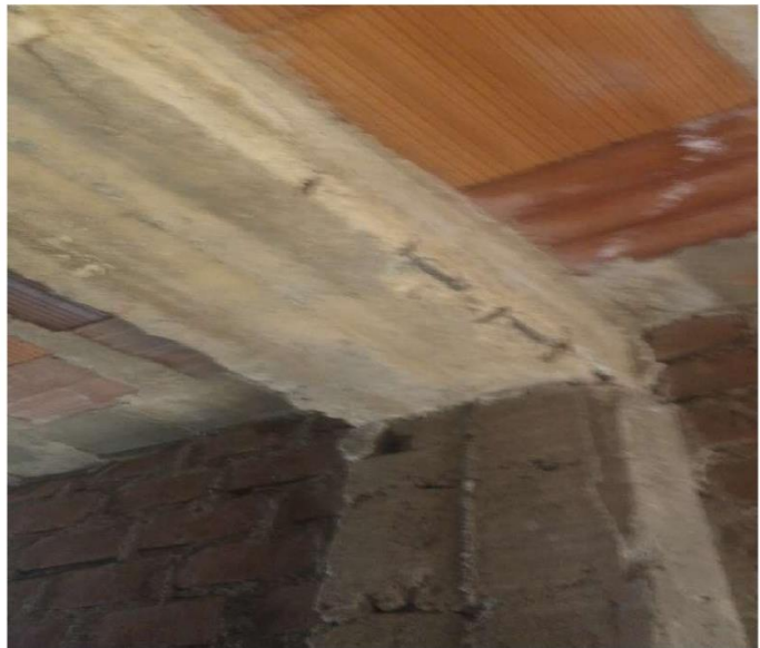
El acero de la viga se puede apreciar, expuesto a la intemperie.
