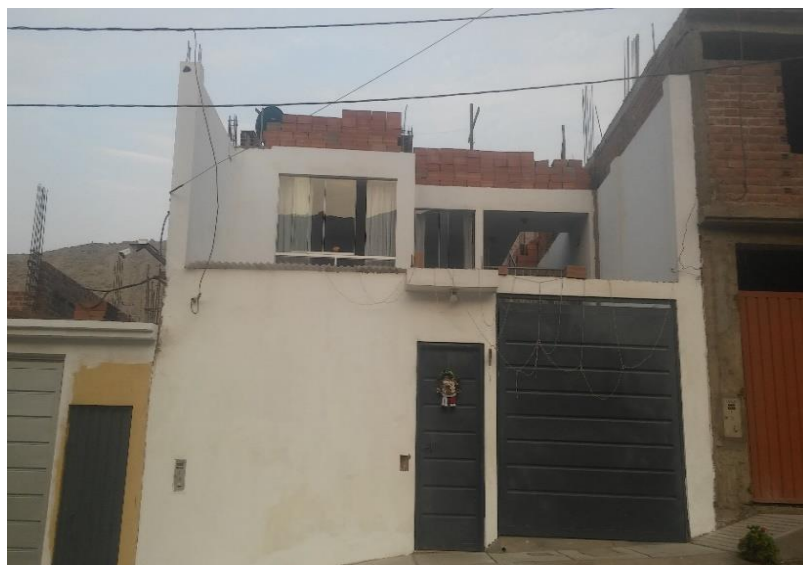
Figura 117.Vivienda construida sin junta sísmica.
