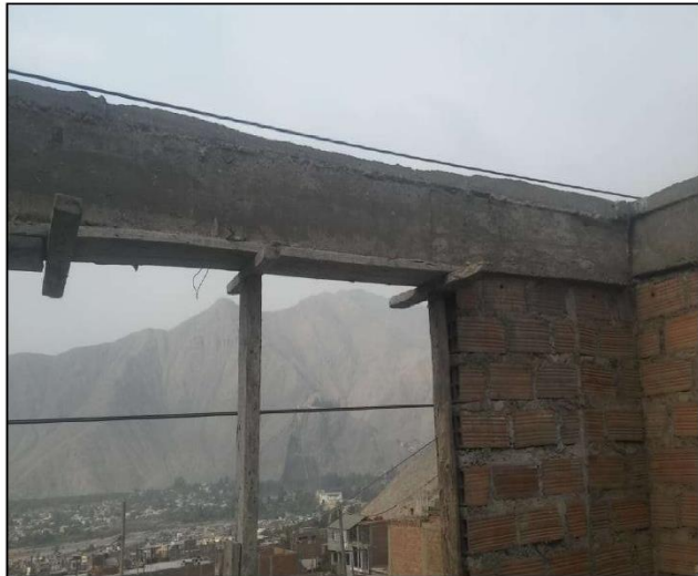
Cangrejera en las vigas. En la imagen se observa que la viga ha sido construida sobre el voladizo sin columnetas de soporte.
