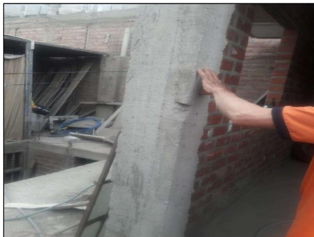
Columna con fisuras, debido al mal desencofrado.
