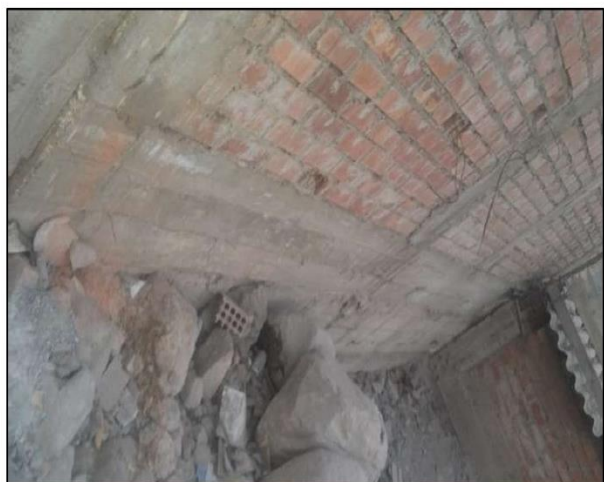
La vivienda presenta problemas de ubicación, se observa el nivel de relleno para la construcción de la vivienda.
