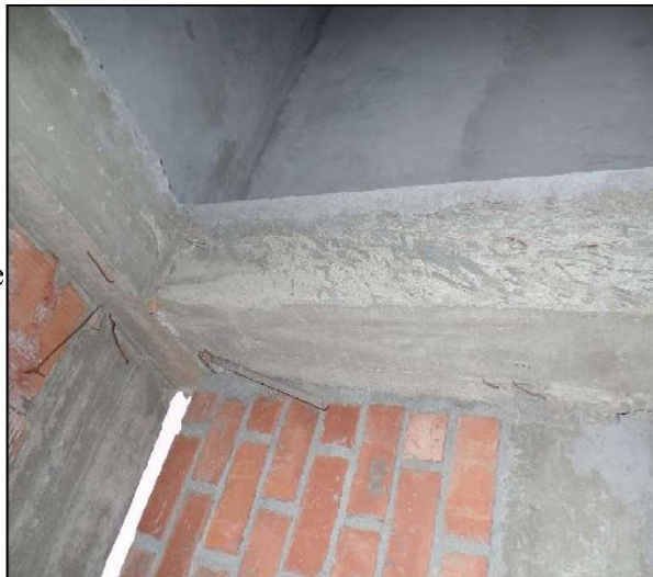
Columna debilitada por la presencia de instalaciones en el interior de la columna.
