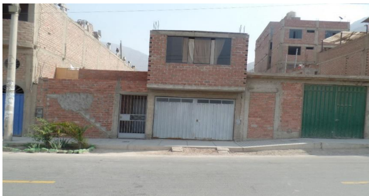
Figura 118.Losa de techo a desnivel con los vecinos adyacentes.
