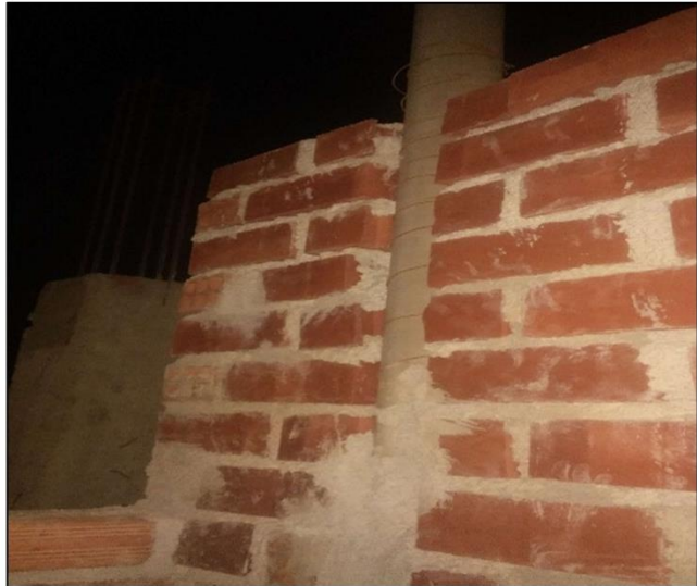
La vivienda tiene instalaciones de tubería en perfectas condiciones debido a que está amarrado mediante un alambre.
