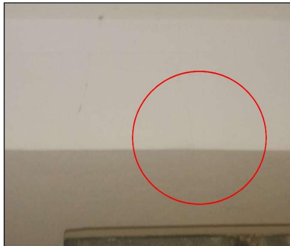
Grietas en las vigas peraltadas
