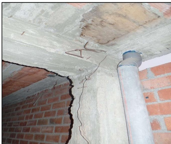
Mala planificación de las instalaciones sanitarias en la vivienda.
