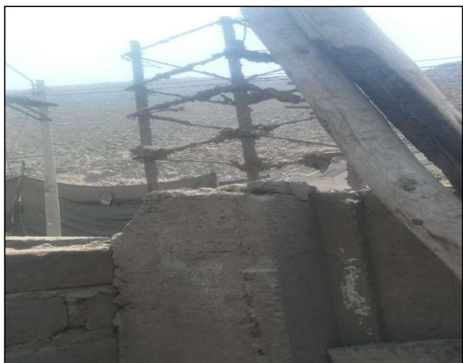
Problemas de corrosión del acero en la techo de la vivienda.
