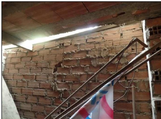
Asentado de ladrillos inadecuado.
