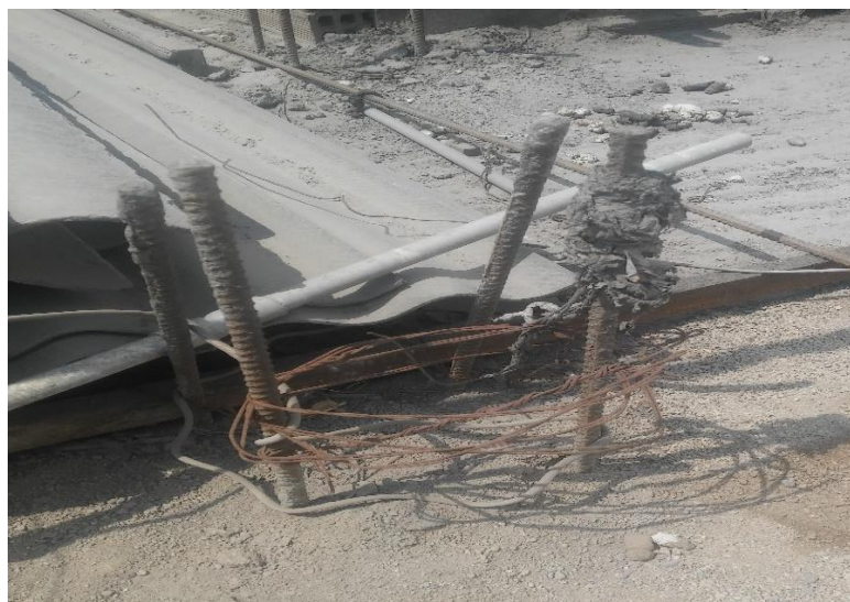
Figura 123. Armaduras expuestas y dobladas en la intemperie.
