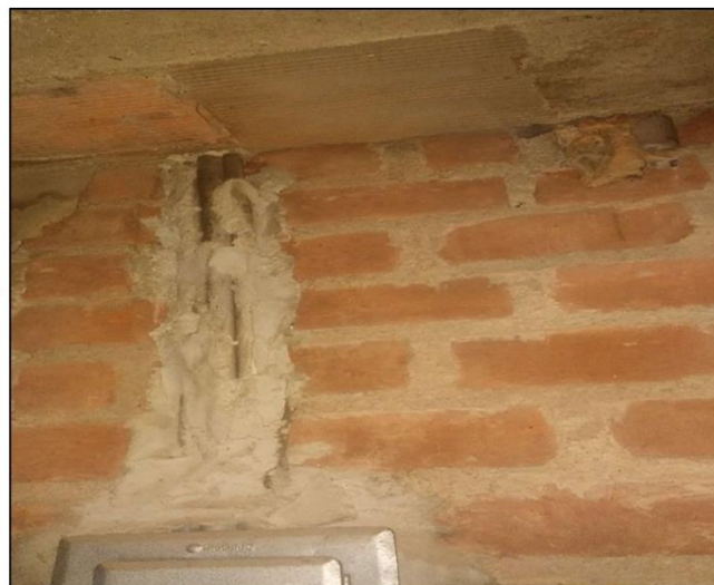
Mala planificación de las instalaciones eléctricas, por lo que debilitan los muros, o en algunos casos los elementos estructurales.
