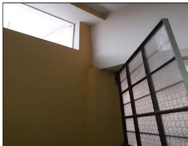
Discontinuidad de las columnas, no existe amarre entre la viga y la columna.
