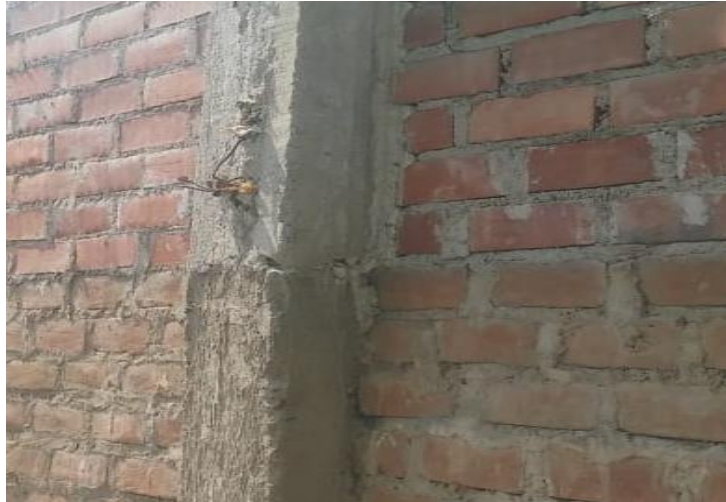
Figura 122. Junta de frías en la columna.
