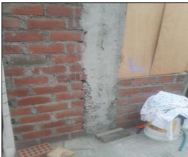
Cangrejera en la columna del segundo piso de la vivienda.
