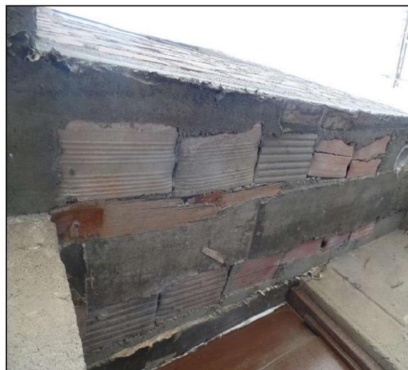
Colocación incorrecta de los ladrillos de techo debido a que se encuentran desalineadas.
