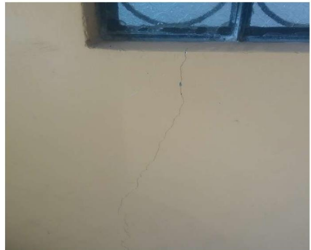
Fisuras en los muros de la vivienda
