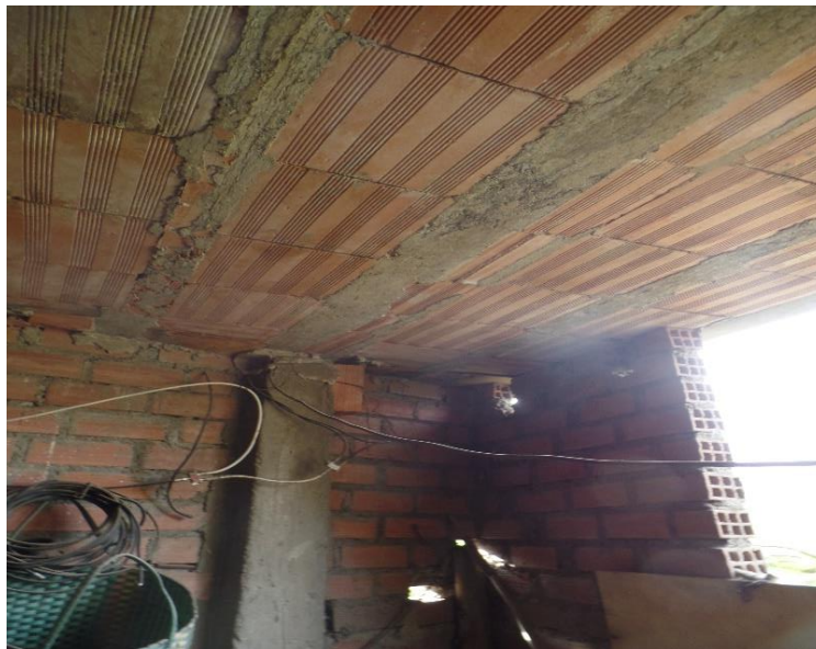
Figura 121. Muro no unido con la losa de la vivienda.
