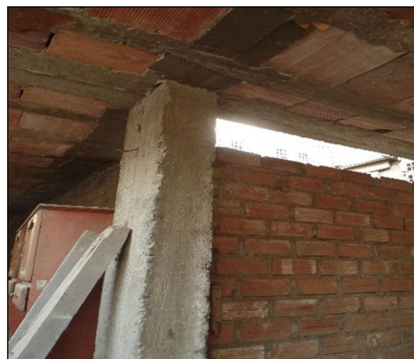
Mal desencofrado en las columnas originando las irregularidades en su aspecto.
