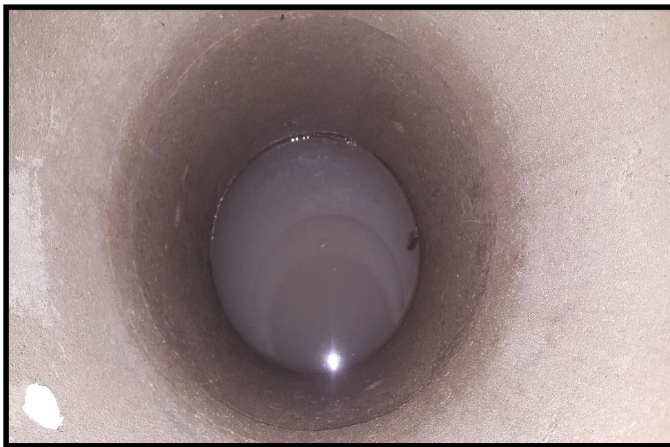
Fotografía 5. Evaluación De Pozo De Agua Contaminada.
