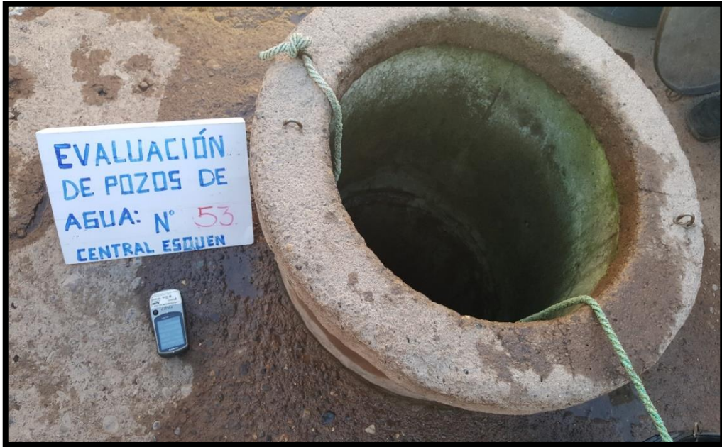
Fotografía 3. Evaluación De Pozo De Agua N°53 - Sin Tapa.
