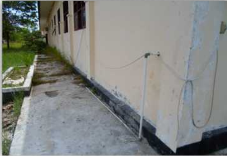
Gambar 7. Instalasi air bersih
