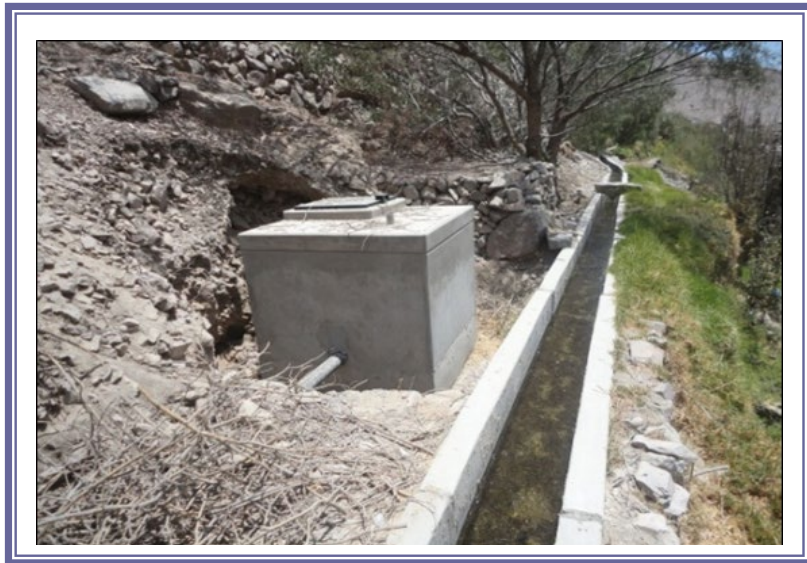
FOTO N° 07: cámara de válvula de aire n° 1 - progresiva
