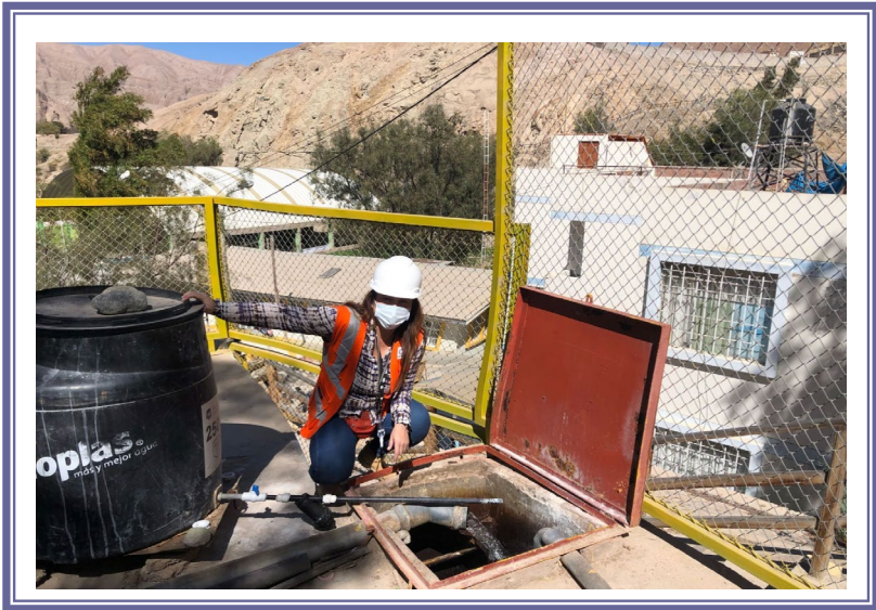
FOTO N° 08: Reservorio que alimenta la red de Ilabaya
