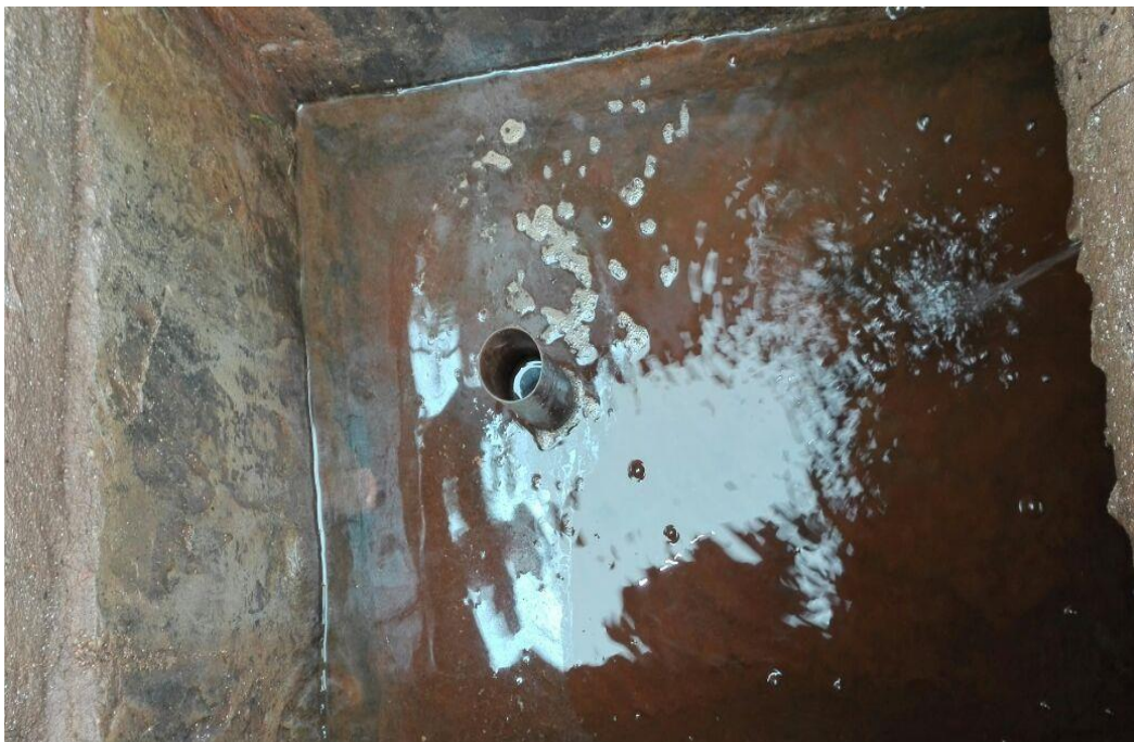
Figura N°04. Pileta construida artesanalmente en muy mal estado de conservación.
