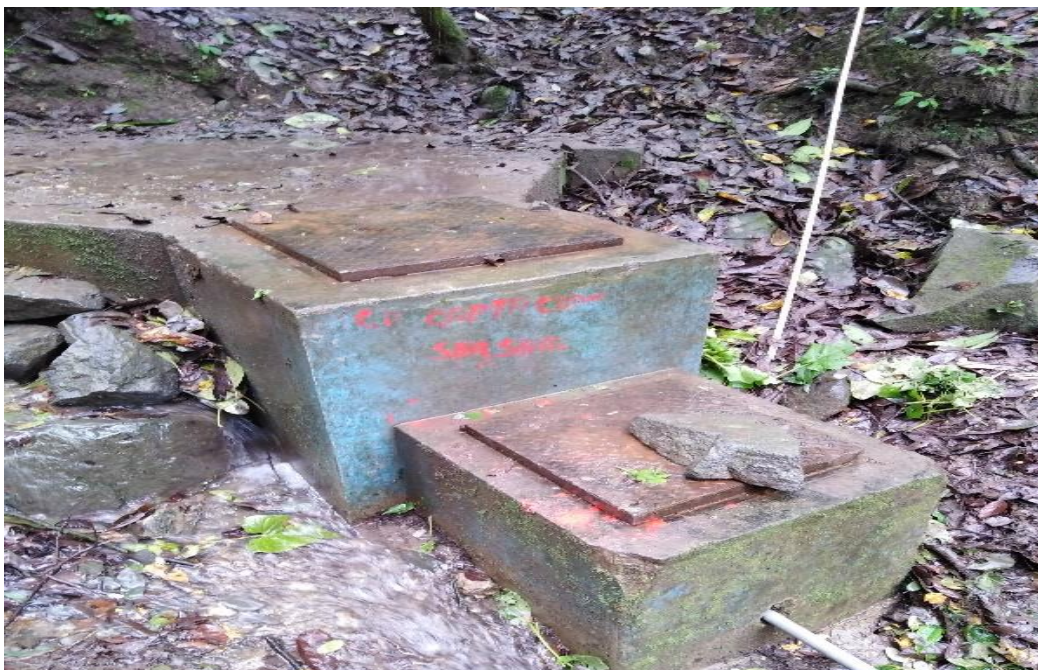
Figura 01. Captación en mal estado del caserío Cangrejera (Fuente propia)
