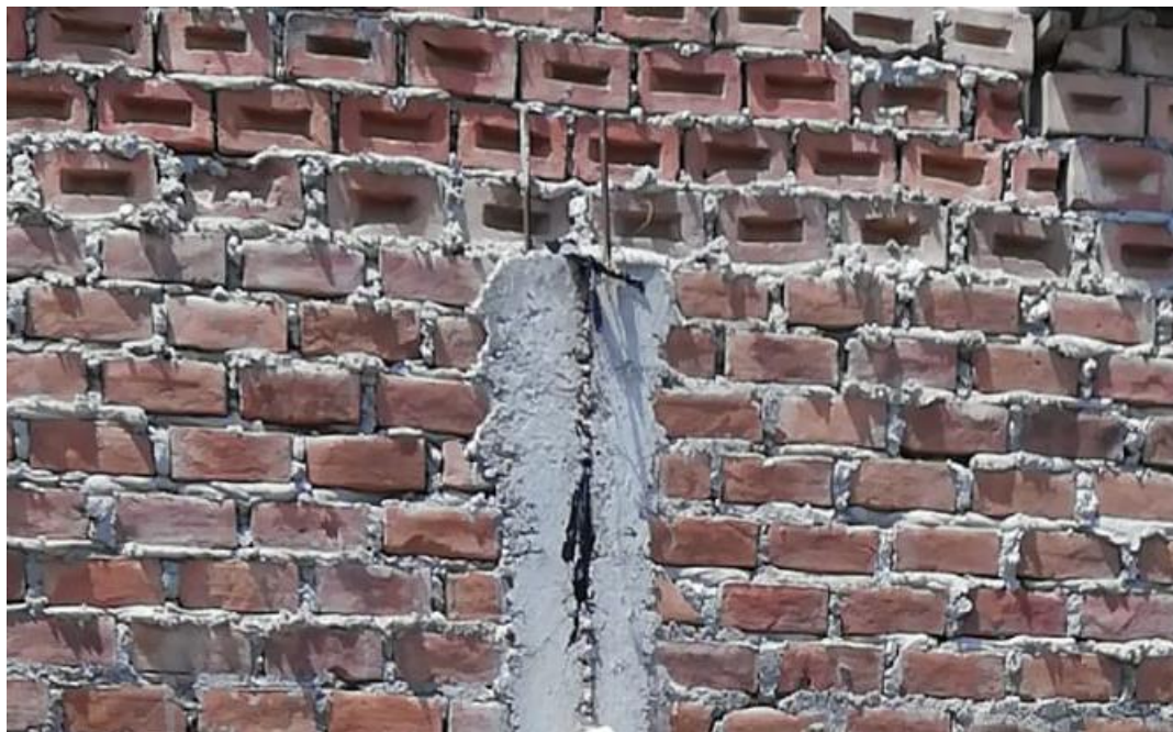
Discontinuidad de columna de confinamiento y cambio de aparejo en el asentado de la unidad de albañilería.
