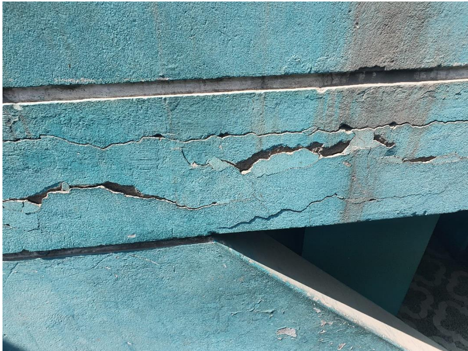
Grietas en los elementos estructurales horizontales.
