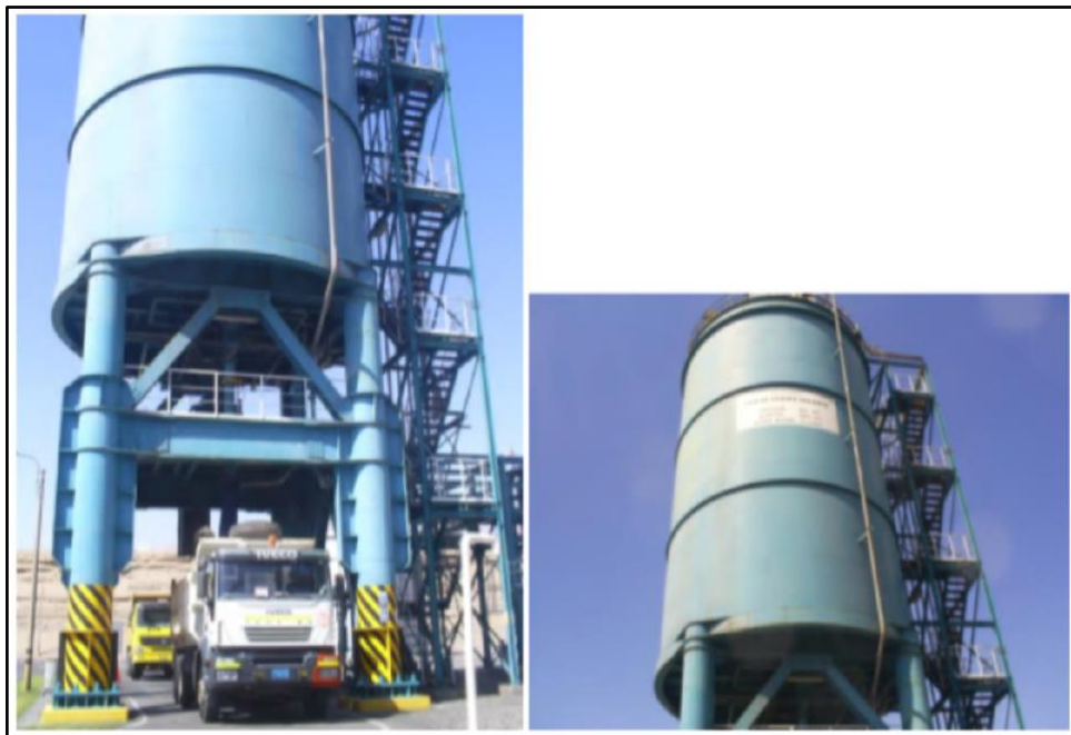
Figura 9. Vista de los Silos donde se Almacena la Ceniza Volante
