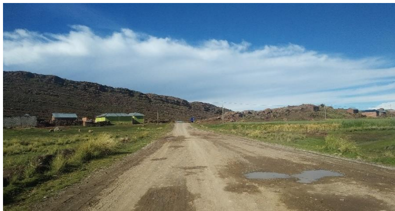
Figura 1. Carretera con fallas en la superficie de rodadura
