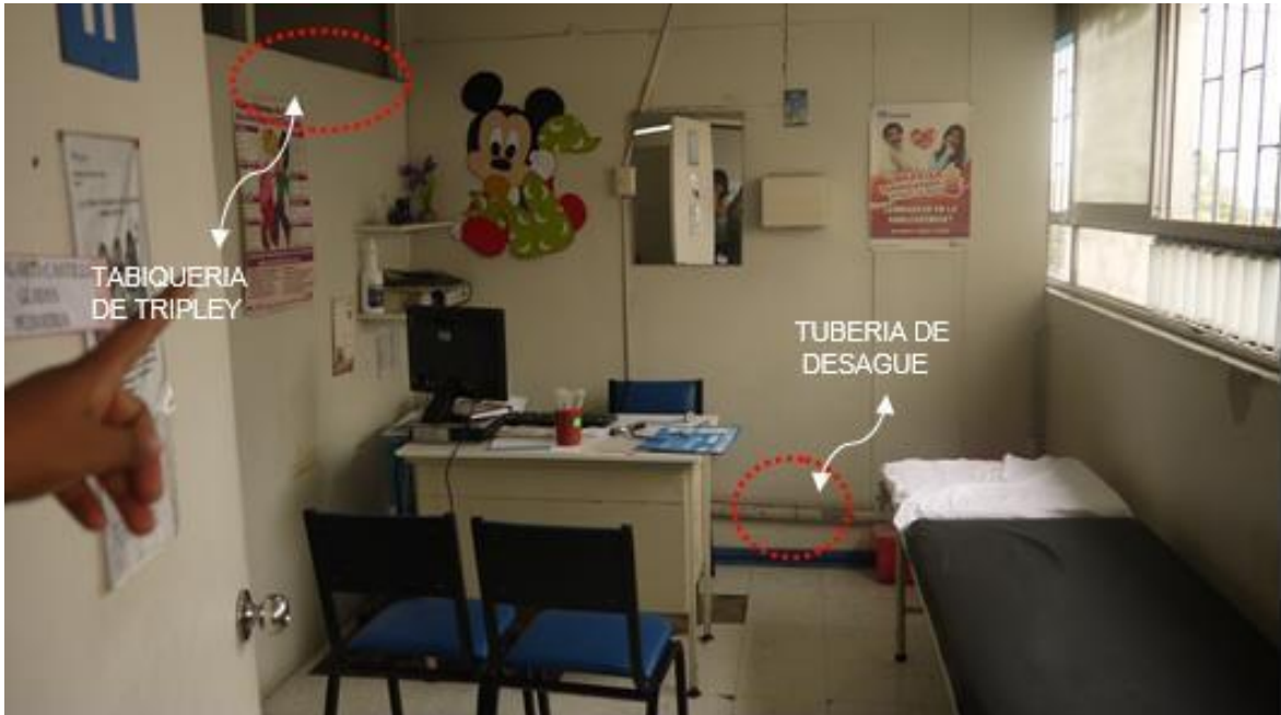
Gráfico 5. Muros con triplay, tuberías de desagüe 3er piso consultorio pediatría Policlínico San Luis
