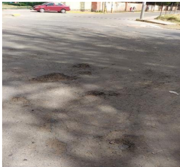
Figura 5. Avenida deteriorada salcedo
