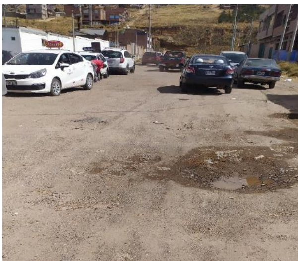
Figura 6. Estado actual de calles y avenida salcedo
