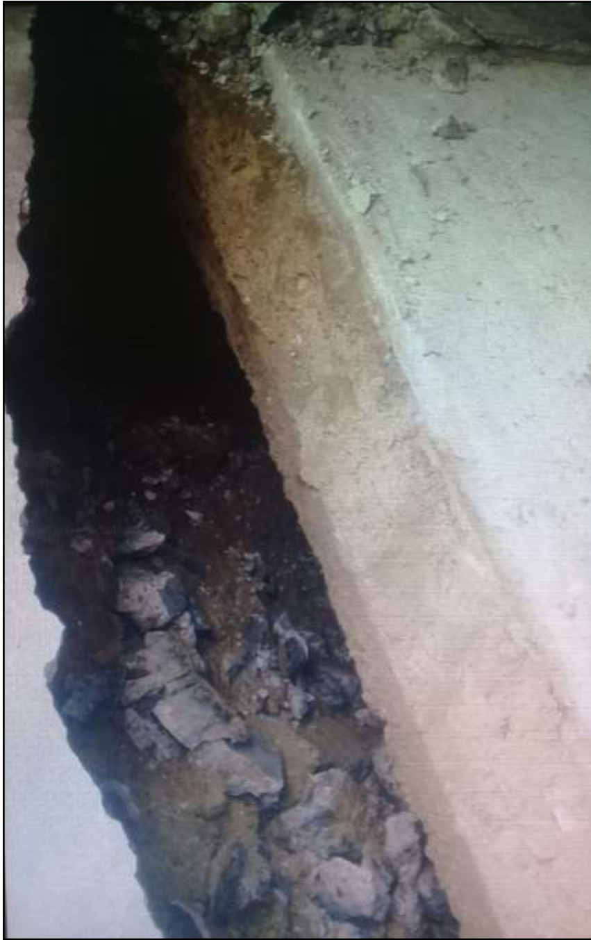
Figura N°01: Vista de Socavamiento de las paredes en la superficie del pozo tubular
