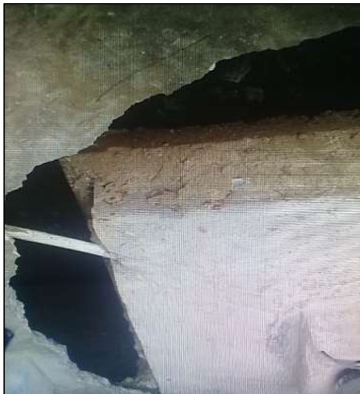
Figura N.º3: Otra vista del socavamiento en la superficie del pozo tubular
