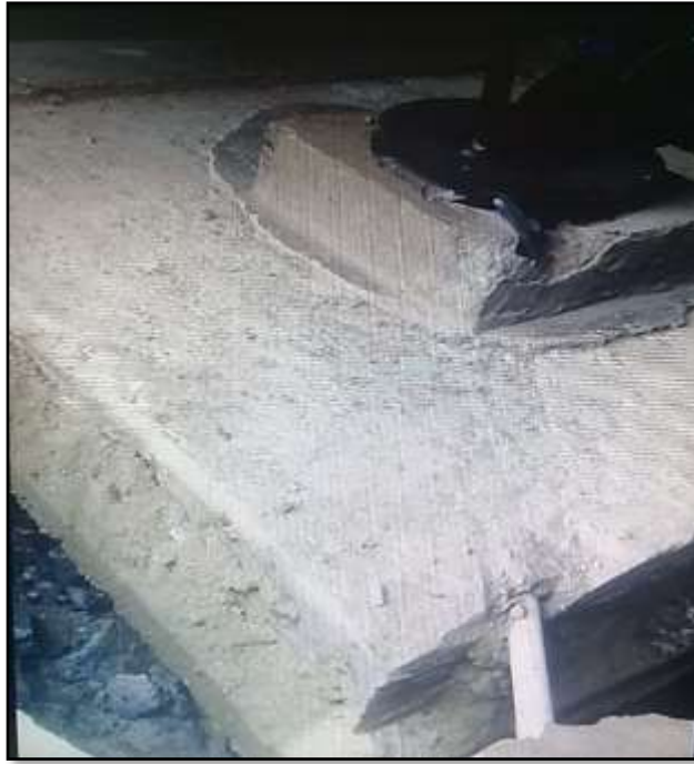
Figura N.º2: Vista del socavamiento alrededor de la superficie del pozo tubular
