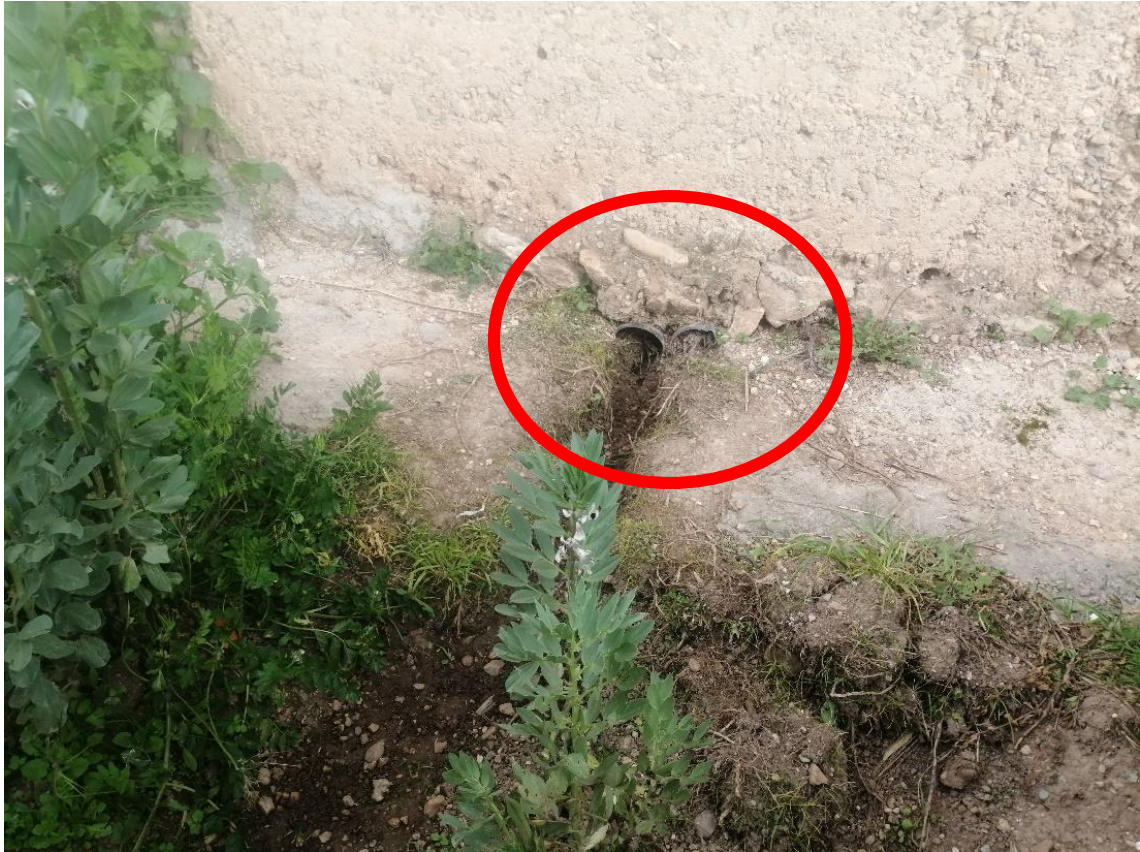
Figura 1: Tuberías de salida de aguas residuales provenientes de una vivienda en el anexo de Ñahuimpuquio.
