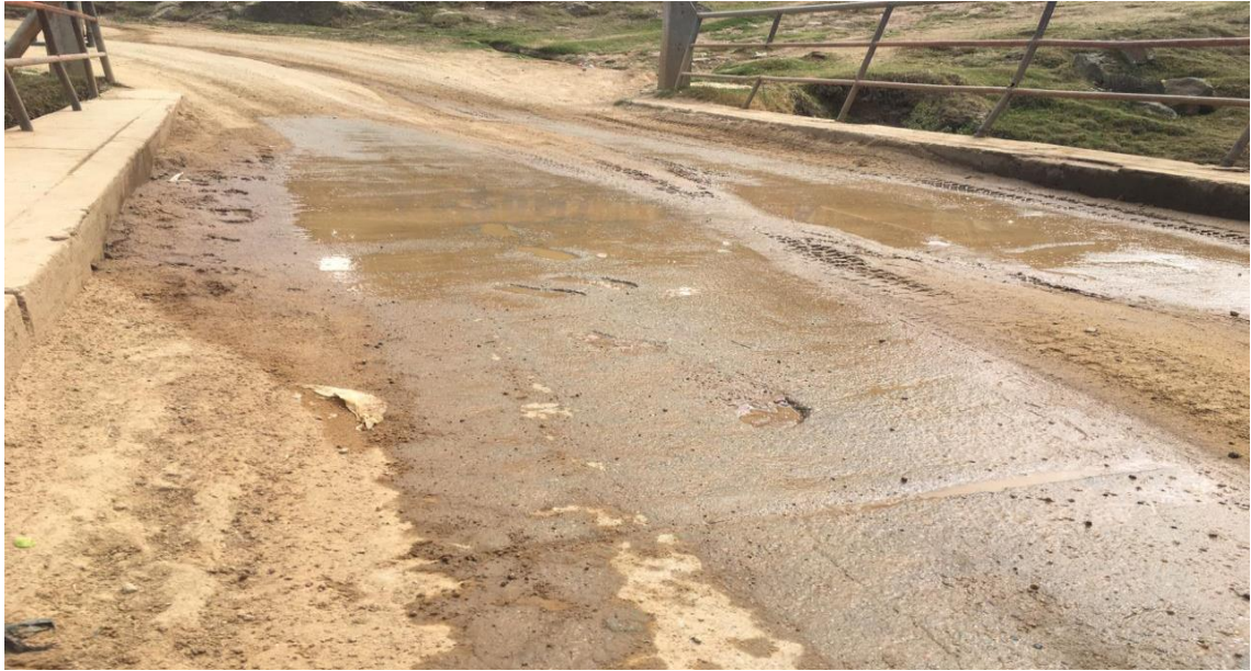
Fallas de la losa por descascaramientos, agrietamientos, descascaramientos
