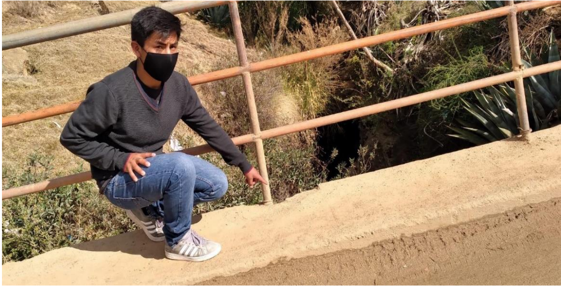
Fallas de la vereda por agrietamientos, descascaramientos
