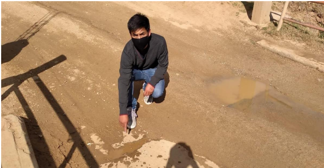
Fallas de la losa por descascaramientos
