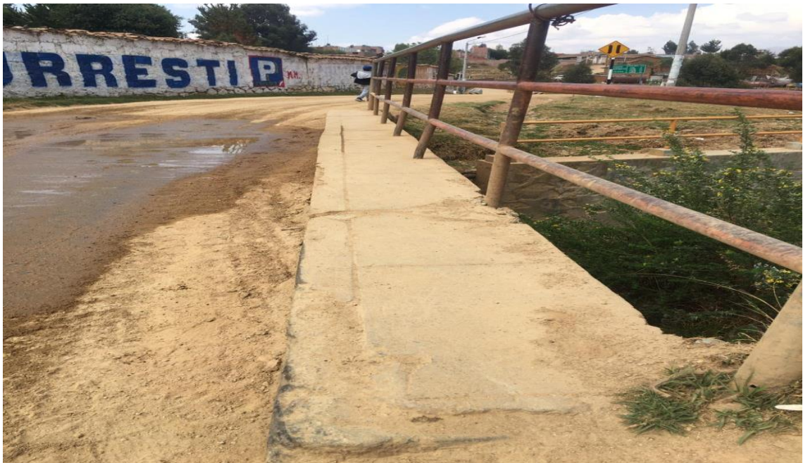
Fallas de la vereda por agrietamientos, descascaramientos
