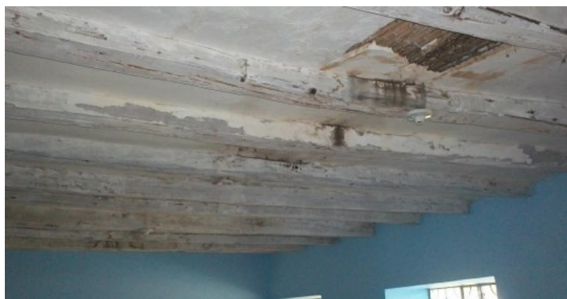
Figura 64 Vista en el interior del aula detallando condición del techo raso
